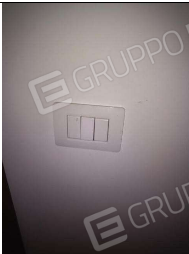
Foto 14. Particolare della tipologia di prese dell'impianto elettrico
