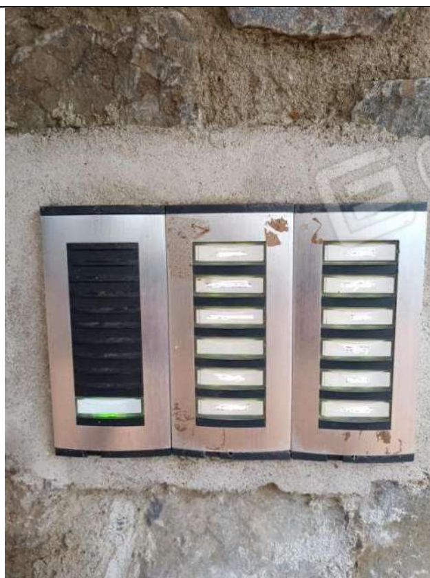
Foto 19. Particolare del sistema citofonico posto all'interno dell'immobile
