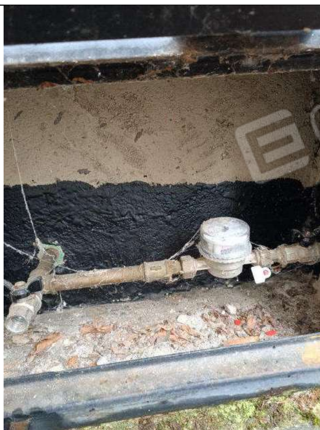
Foto 15. Particolare del quadro-comandi del servizio idrico-sanitario
