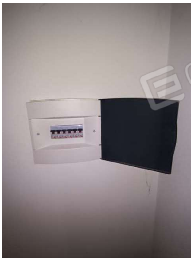
Foto 13. Particolare della tipologia di interruttori dell'impianto elettrico
