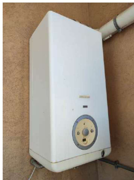
Foto 24: Particolare caldaia autonoma
