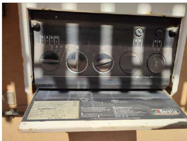
Foto 17: Particolare caldaia autonoma
