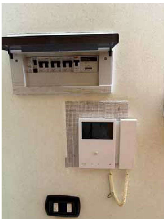
Foto 15: Particolare quadro elettrico generale e videocitofono
