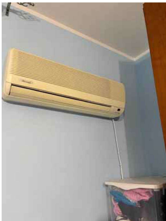
Foto 13: Condizionatore autonomo camera
