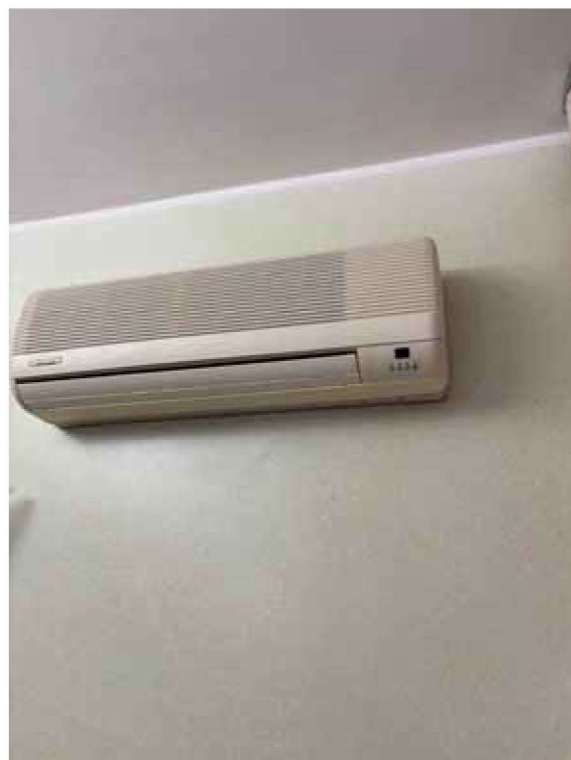
Foto 14: Condizionatore autonomo soggiorno
