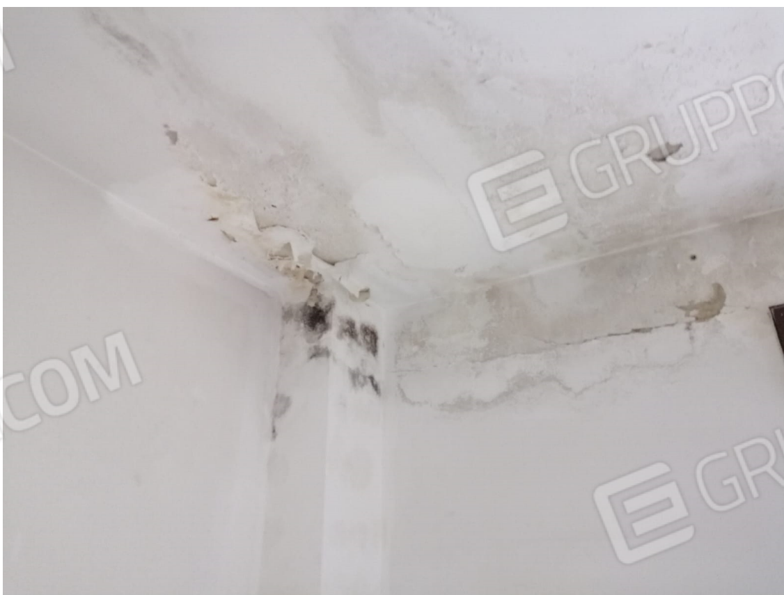
Foto 18 – Pesanti infiltrazioni di acqua dal soffitto della seconda camera del piano primo.
