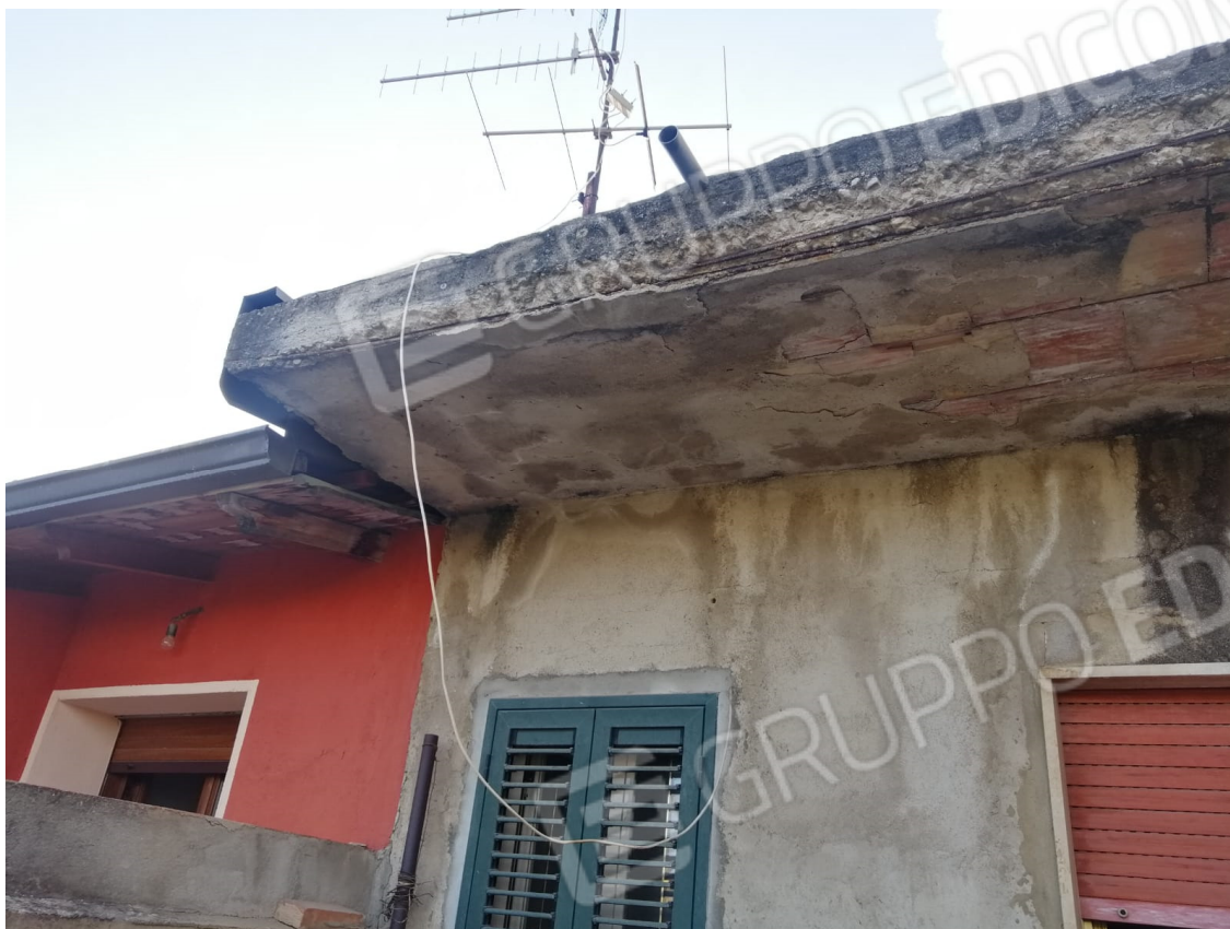
Foto 15 – Distacco dell'intonaco dal cornicione soprastante il terrazzo del piano primo.
