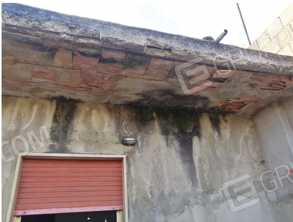
Foto 16 – Ingrandimento sul cornicione sfondellato.
