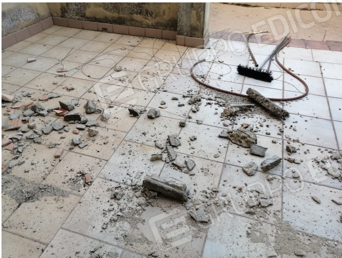
Foto 17 – Calcinacci e pezzi di mattoni caduti sul terrazzo del piano primo.
