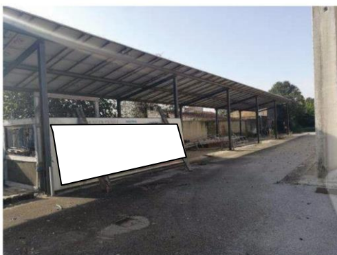
foto 43: ... Pensilina con fotovoltaico
