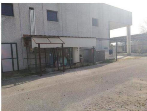
foto 45: ... impianto di climatizzazione
