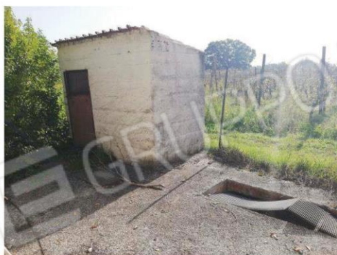
foto 52: ...manufatto depuratore sulla p.lla 57
