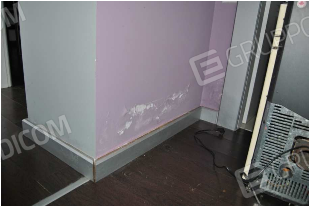
Foto 20 – 21.01.2016 – Fabbricato p.la 442 area amministrativa/commerciale: deterioramento, rigonfiamento e screpolatura della pittura della parete, fenomeni di muffa
