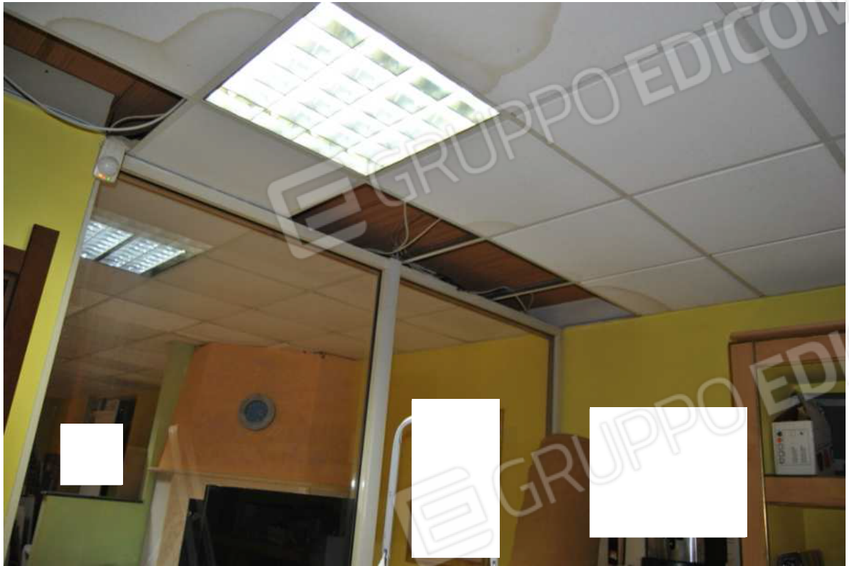
Foto 43 – 21.01.2016 – Area espositiva nel volume abusivo: vista della controsoffittatura con pannelli mancanti e fenomeni di muffa
