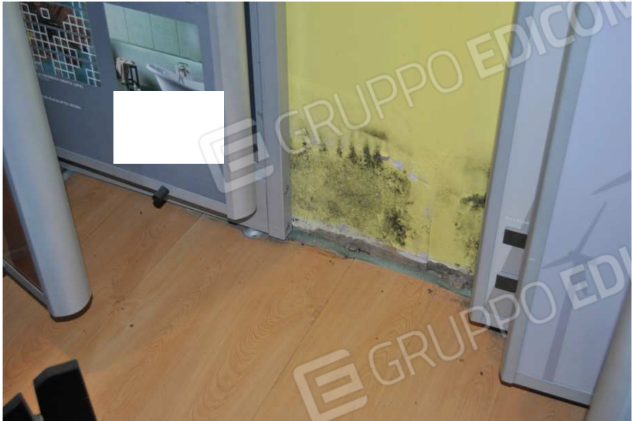
Foto 29 – 21.01.2016 – Fabbricato p.la 443 area espositiva: deterioramento e sollevamento del parquet lungo le linee di fuga dei listoni; distacco del battiscopa; deterioramento, rigonfiamento e screpolatura della pittura della parete, fenomeni di muffa
