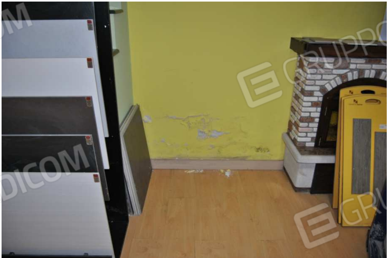
Foto 40 – 21.01.2016 – Area espositiva nel volume abusivo: sollevamento del parquet lungo le linee di fuga dei listoni; deterioramento, rigonfiamento e screpolatura della pittura della parete, fenomeni di muffa
