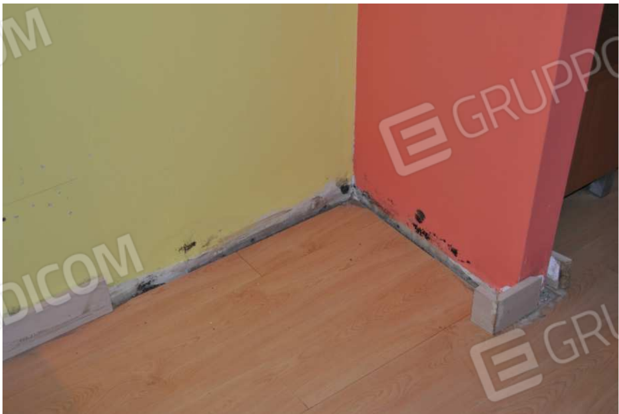
Foto 30 – 21.01.2016 – Fabbricato p.la 443 area espositiva: sollevamento del parquet lungo le linee di fuga dei listoni; distacco del battiscopa; deterioramento, rigonfiamento e screpolatura della pittura della parete, fenomeni di muffa
