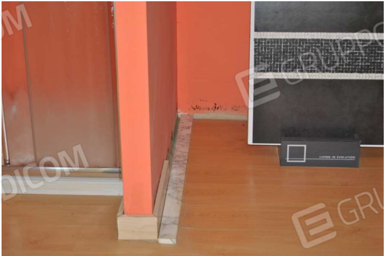
Foto 32 – 21.01.2016 – Fabbricato p.la 443 area espositiva: sollevamento del parquet lungo le linee di fuga dei listoni; distacco del battiscopa; deterioramento, rigonfiamento e screpolatura della pittura della parete, fenomeni di muffa
