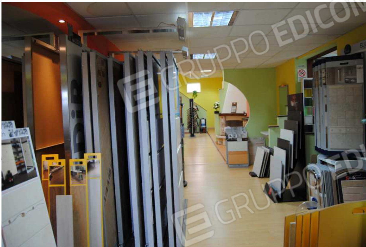
Foto 35 – 27.09.2010 – Area espositiva nel volume abusivo: da notare tracce di umidità su alcuni dei pannelli della controsoffittatura
