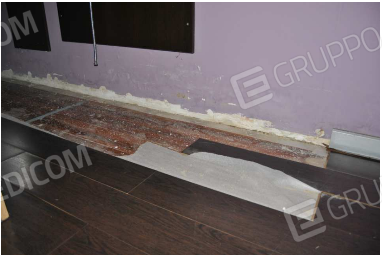
Foto 18 – 21.01.2016 – Fabbricato p.la 442 area amministrativa/commerciale: altra vista dello scollamento e distacco del parquet, distacco del battiscopa, deterioramento, rigonfiamento e screpolatura della pittura della parete
