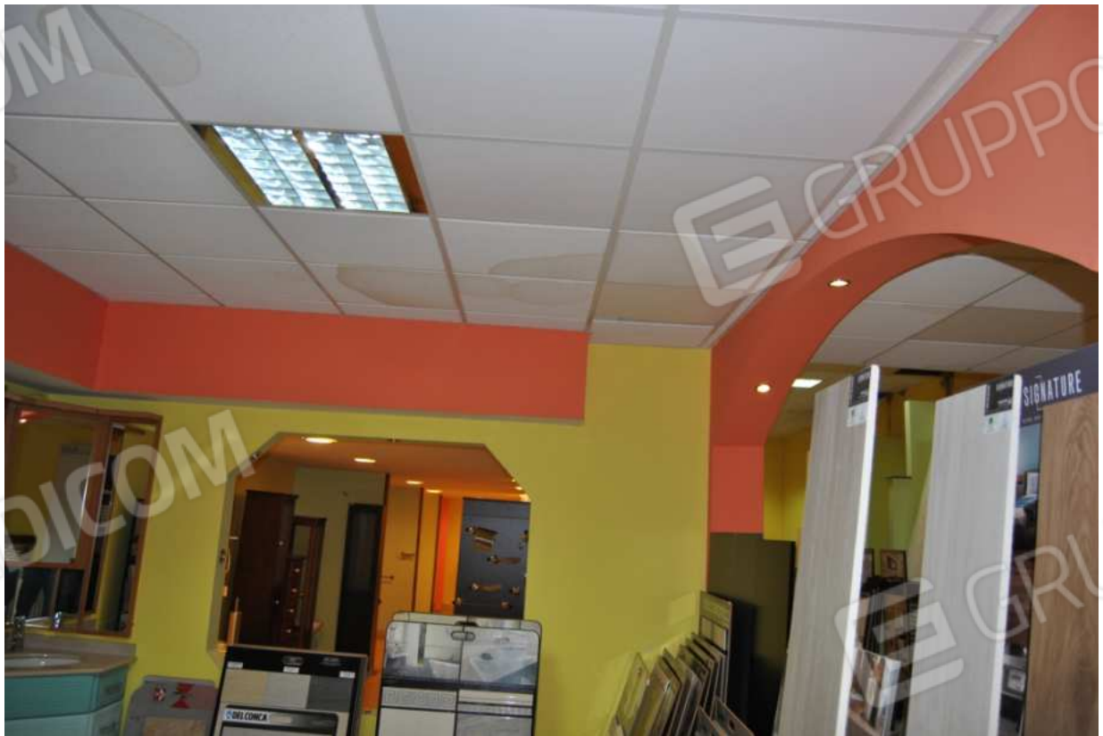
Foto 44 – 21.01.2016 – Area espositiva nel volume abusivo: vista della controsoffittatura con pannelli attaccati da fenomeni di muffa
