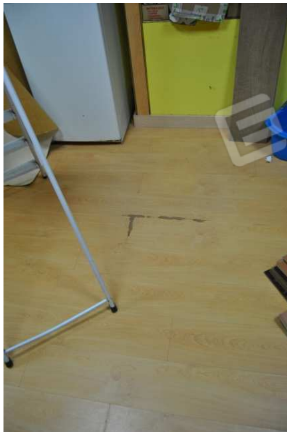
Foto 46 – 21.01.2016 – Area espositiva nel volume abusivo: deterioramento e sollevamento del parquet lungo le linee di fuga dei listoni
