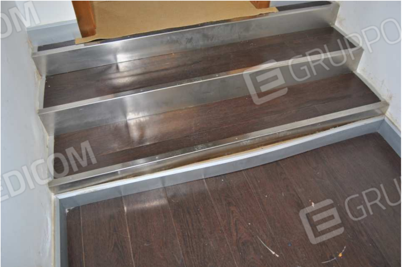
Foto 22 – 21.01.2016 – Fabbricato p.la 442 area amministrativa/commerciale: distacco del battiscopa
