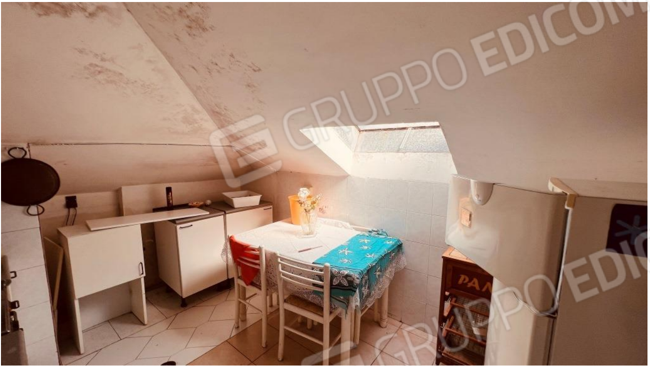
Foto 10 – Vano cucina con lucernaio e macchie d'umidità
