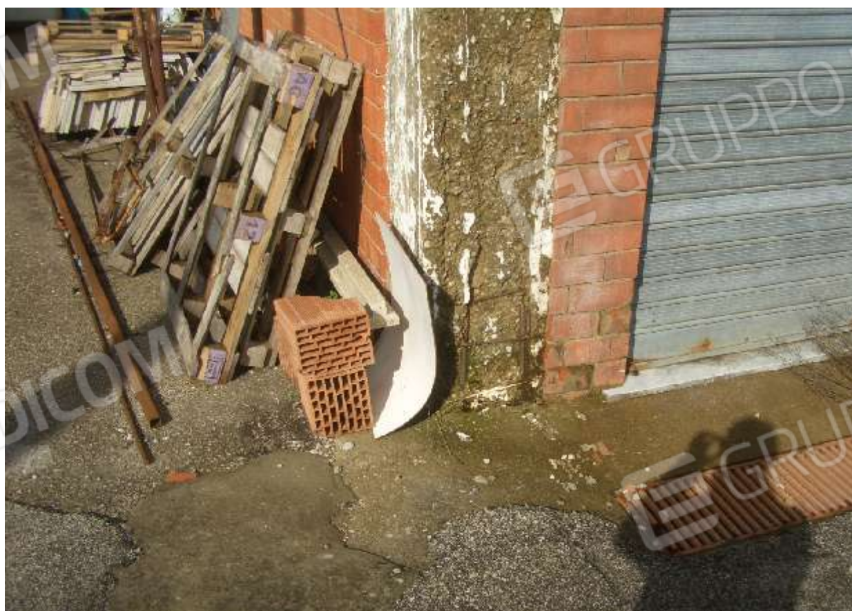
Foto n. 6:... Particolare del degrado...
