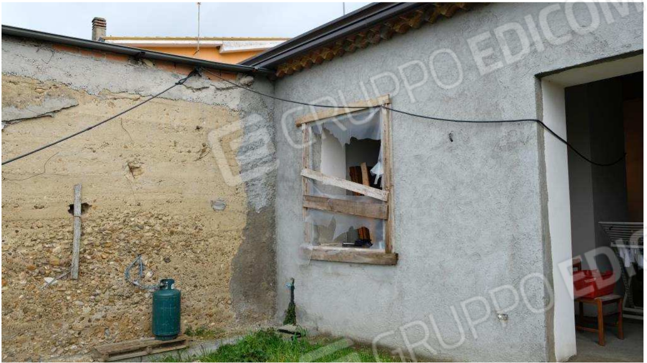
Foto 9 – Dettagli esterni nello stato rustico del fabbricato ex deposito, area del portico
