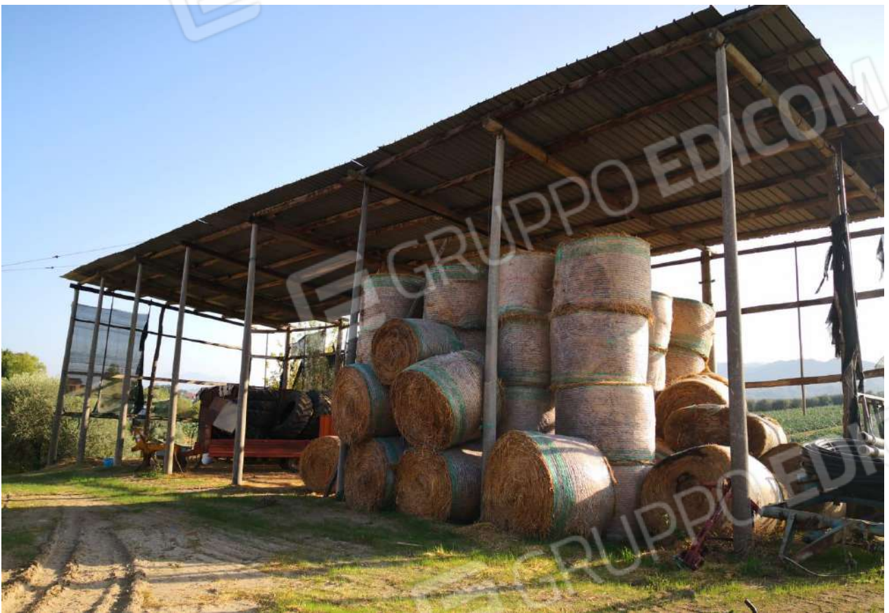
Fotogramma 53 – Tettoia gravante sul mappale 576 ma non accatastata
