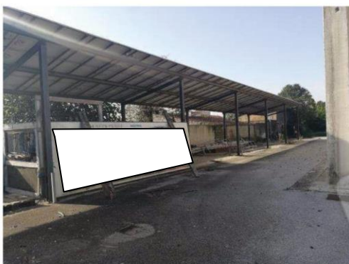
foto 43: ... Pensilina con fotovoltaico
