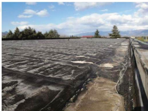
foto 53: ... stato della copertura
