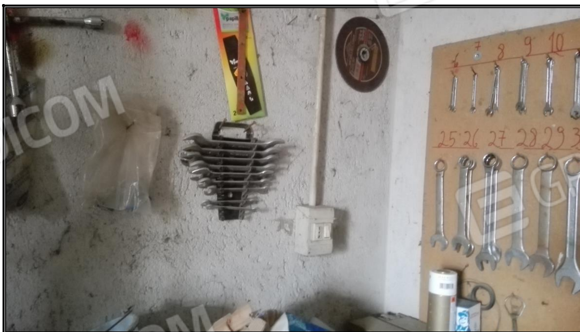
FOTO 4 – Particella 957 sub 2 (Deposito) : impianto elettrico con canaline a vista.
