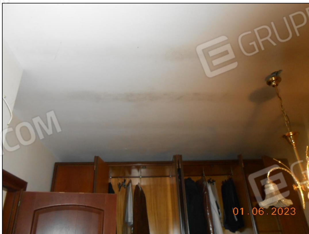
FOTO N. 36 Vista interna dell'immobile. Si notano macchie diffuse di condensa e muffa sul soffitto.
