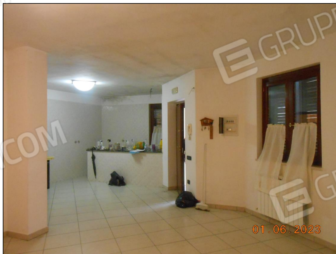
FOTO N. 20 Vista interna dell'immobile. Si notano le macchie di condensa sul soffitto.
