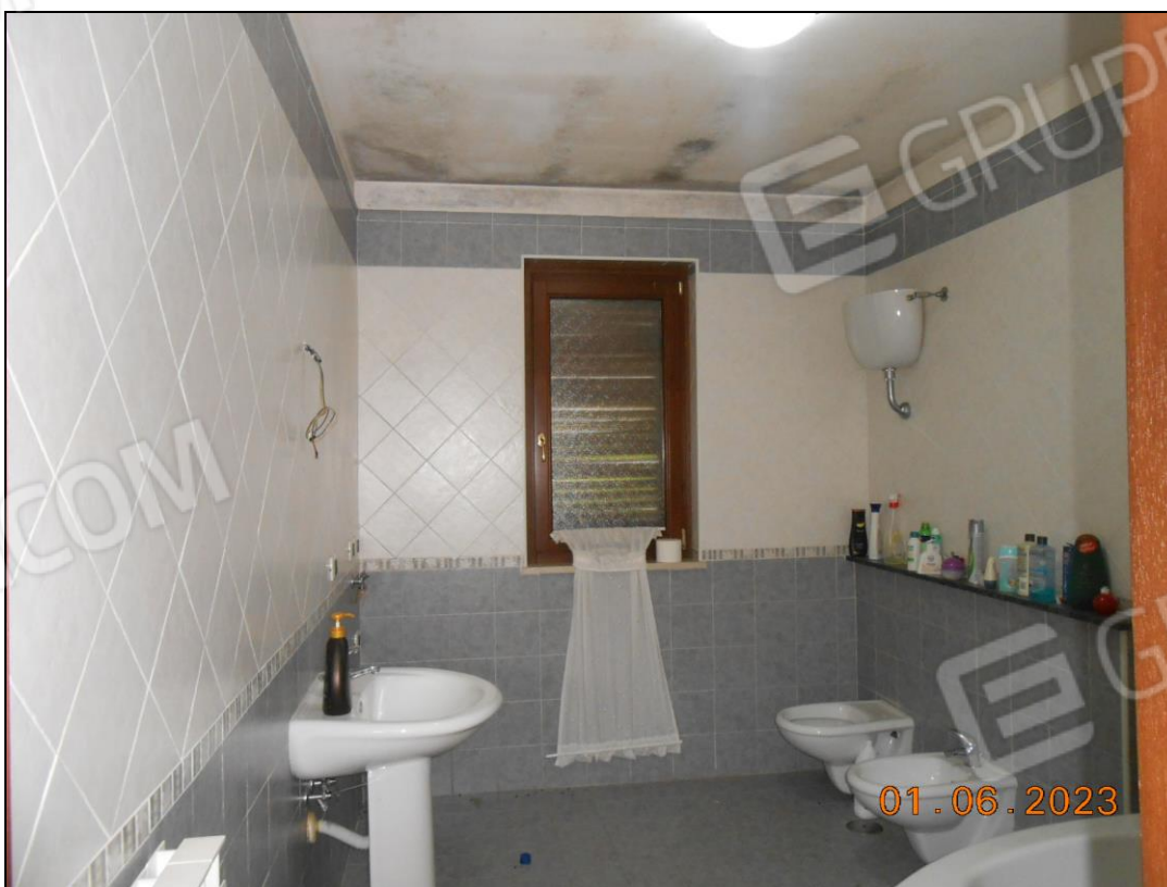
FOTO N. 26 Vista interna dell'immobile. Si notano diffuse macchie di condensa e muffe sul soffitto e pareti.
