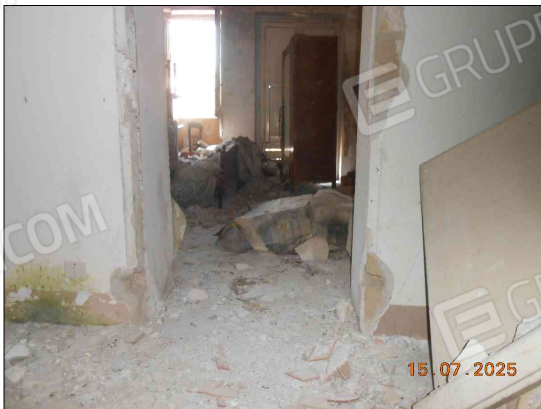
FOTO N. 26 Vista interna piano primo dell'immobile. Si notano calcinacci staccati dal soffitto, più rifiuti e arredi devastati.
