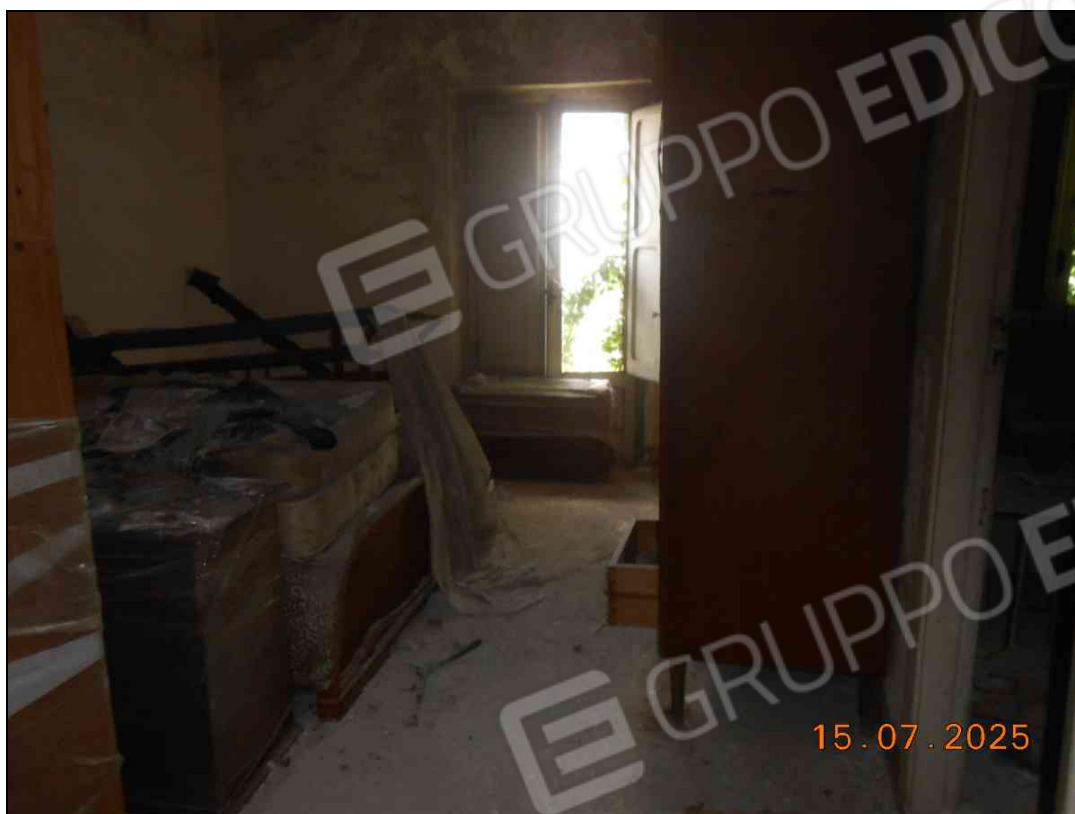
FOTO N. 33 Vista interna del piano primo dell'immobile. Si nota lo stato di degrado.
