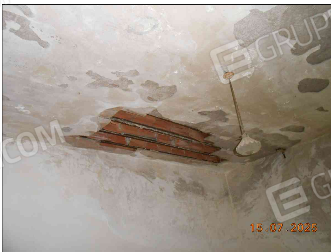
FOTO N. 34 Vista interna del piano primo dell'immobile. Si nota lo sfondellamento del soffitto e le infiltrazioni meteoriche.
