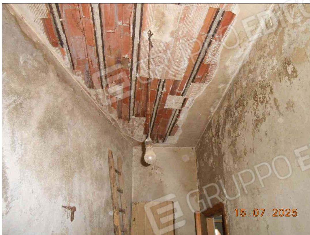
FOTO N. 23 Vista interna piano terra. Si nota il solaio sfondellato.
