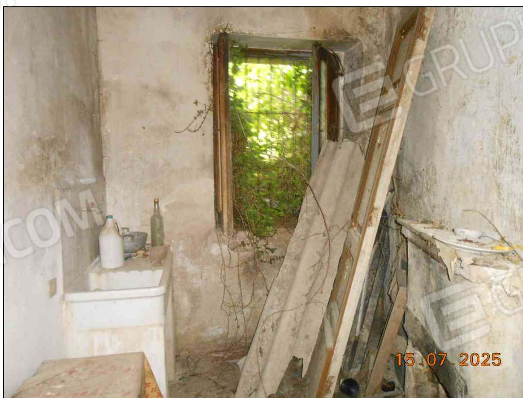
FOTO N. 22 Vista interna piano terra. Si nota lo stato di degrado e lastre di Eternit da smaltire (rifiuti speciali pericolosi).
