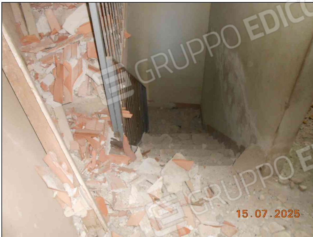
FOTO N. 25 Vista interna piano primo dell'immobile. Si notano calcinacci di laterizi derivati dal soffitto.
