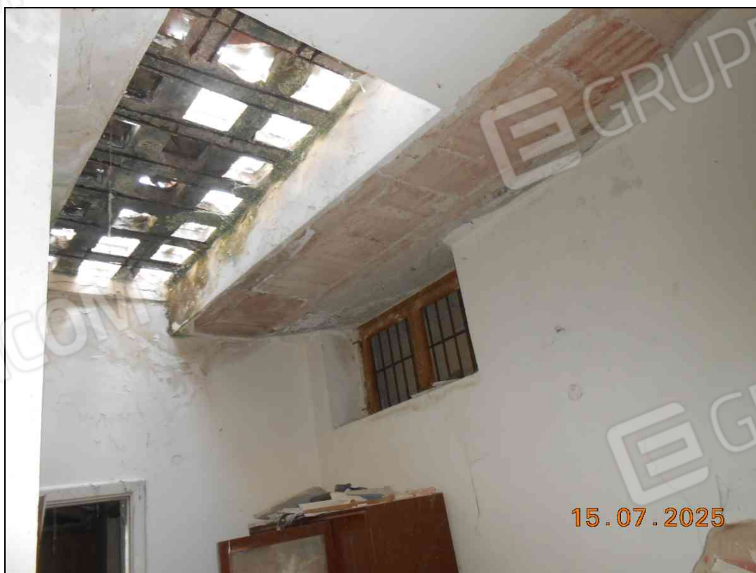
FOTO N. 32 Vista interna del piano primo. Si notano infiltrazioni dalla copertura piana.
