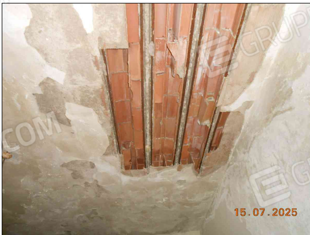
FOTO N. 38 Vista interna del piano primo dell'immobile. Si nota lo sfondellamento del soffitto.
