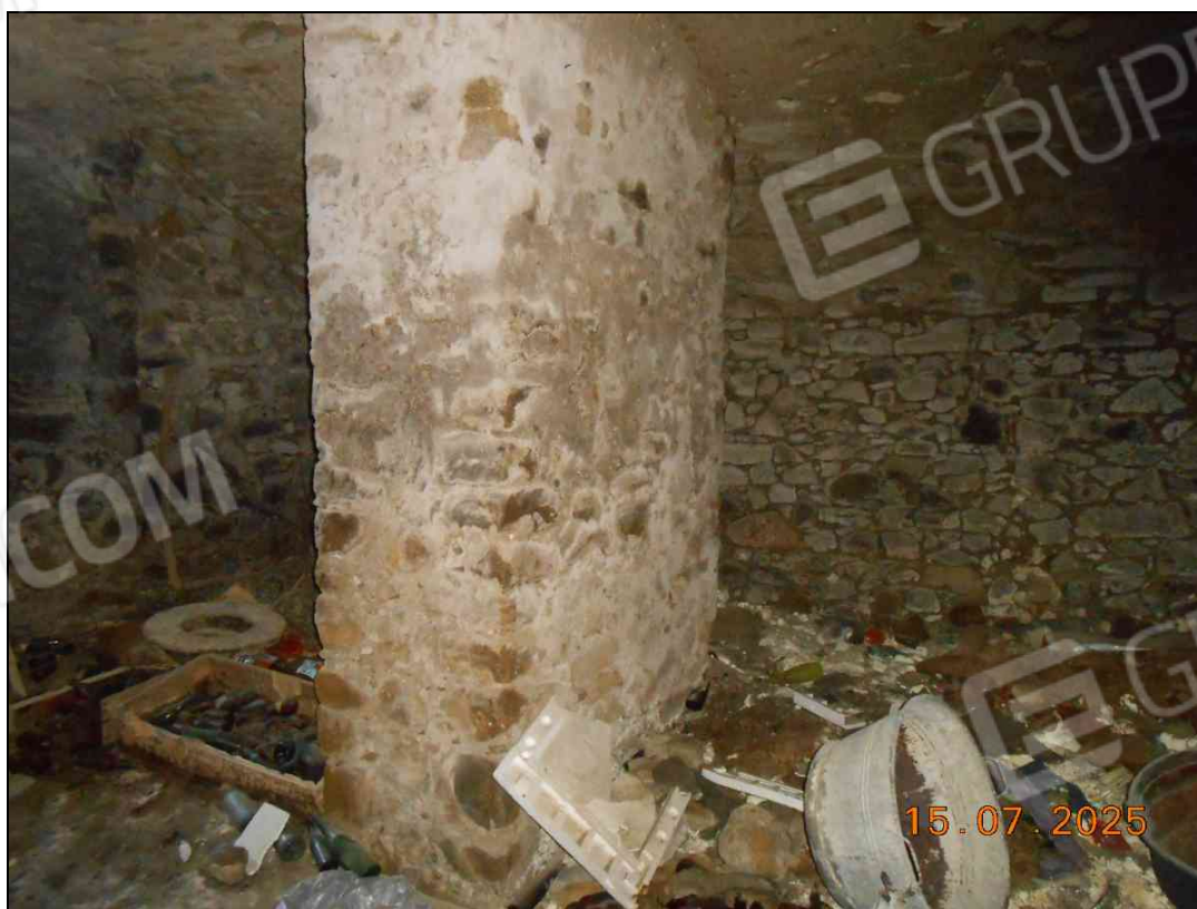
FOTO N. 08 Vista del locale al piano interrato. Si nota lo stato di degrado e materiali di ogni genere.
