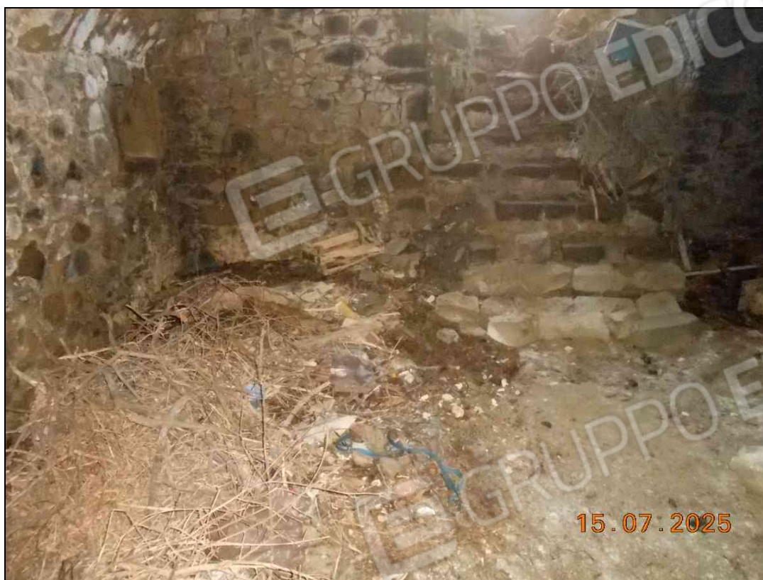
FOTO N. 09 Vista del locale al piano interrato. Si notano le precarie condizioni del locale.
