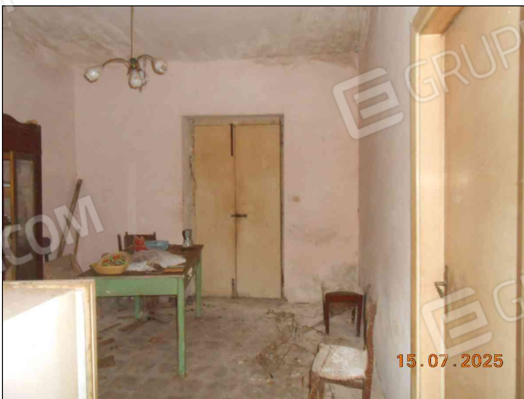
FOTO N. 18 Vista interna immobile al piano terra. Si nota lo stato di degrado e le infiltrazioni meteoriche nel solaio.
