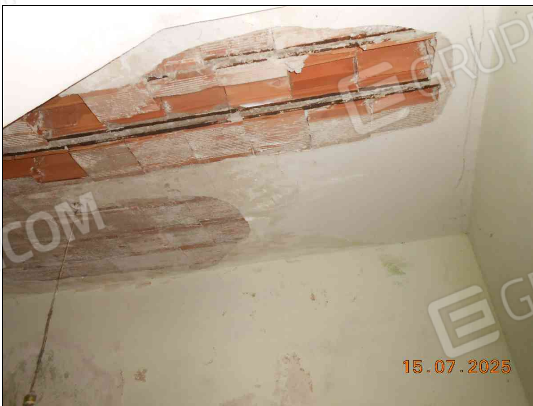
FOTO N. 16 Vista del solaio sfondellato.
