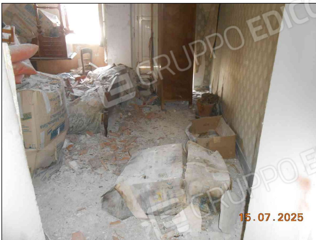
FOTO N. 27 Vista interna piano primo dell'immobile. Si notano calcinacci staccati dal soffitto, più rifiuti e arredi devastati.
