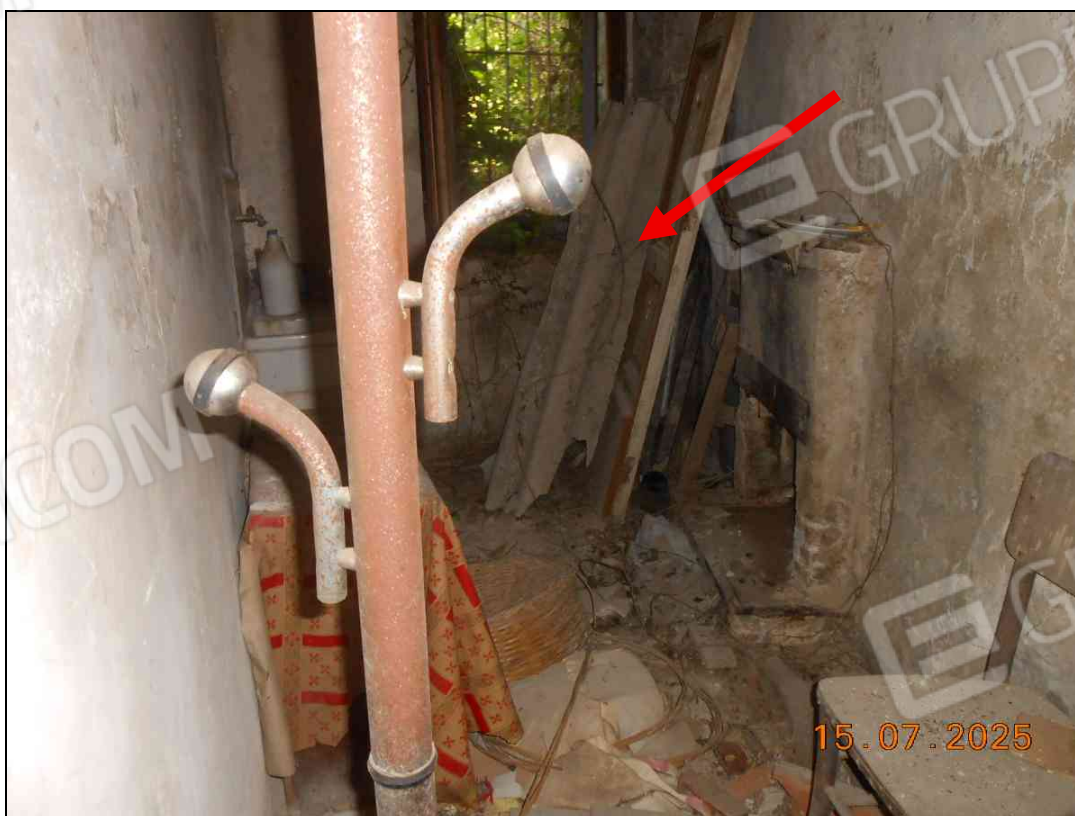
FOTO N. 20 Vista interna immobile al piano terra. Si nota lo stato di degrado e la presenza di lastre di amianto (Eternit) da smaltire (rifiuti speciali pericolosi).
