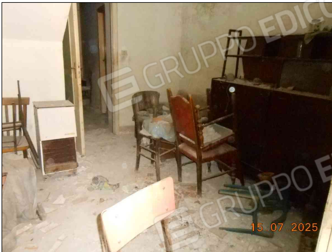
FOTO N. 15 Vista interna immobile al piano terra. Si nota lo stato di degrado.
