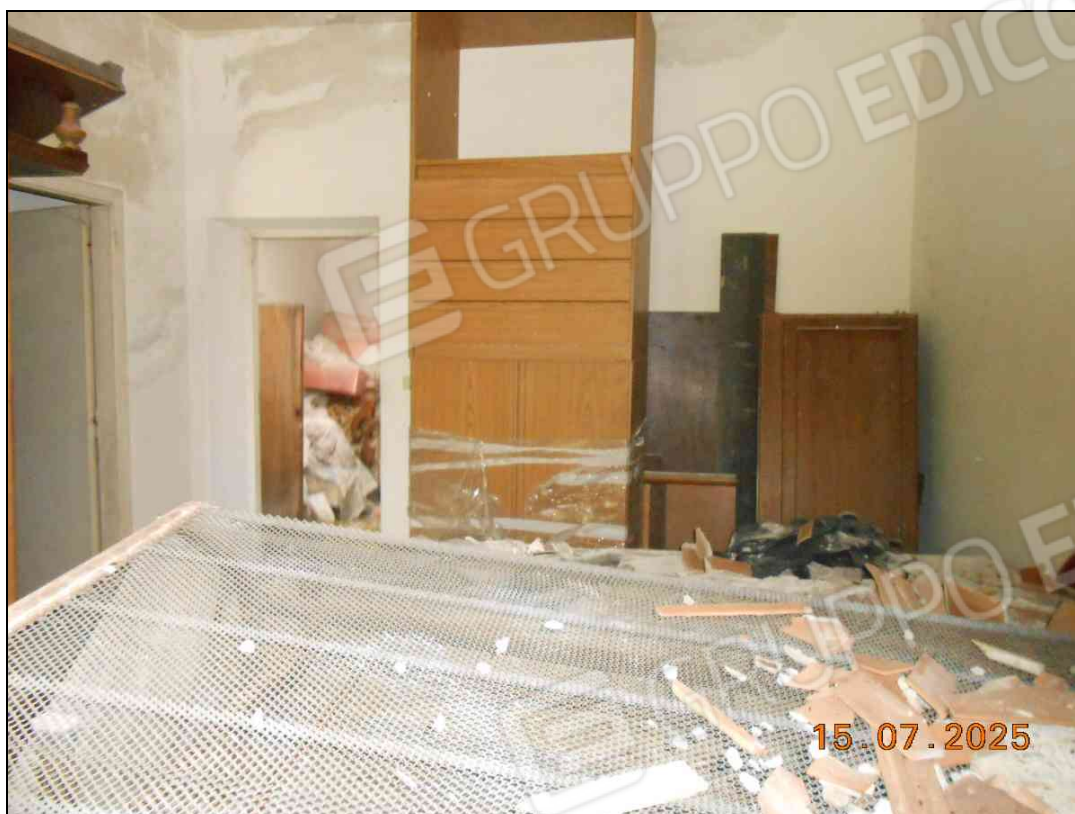
FOTO N. 37 Vista interna del piano primo dell'immobile. Si notano calcinacci crollati dal soffitto.
