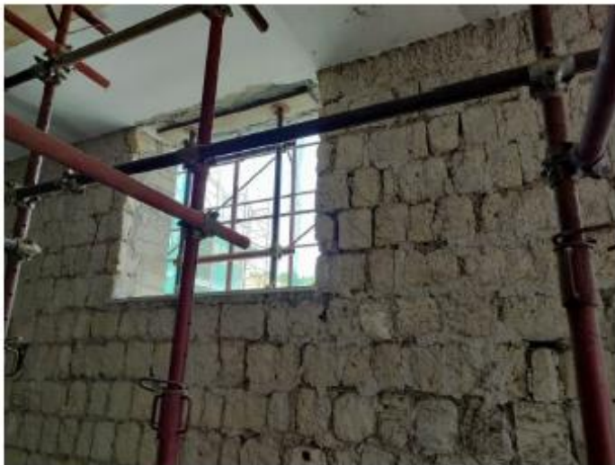
Vista della muratura del piano terra NON consolidata con polverizzazione dei giunti con potenziale pericolo di dissesto.
