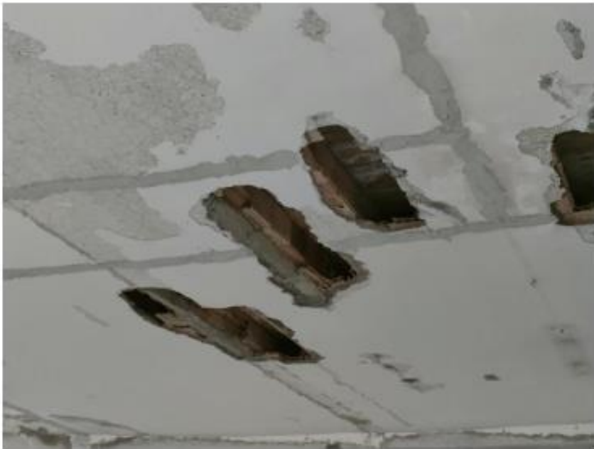
Vista del solaio del secondo impalcato (tipo SAP) in stato di avanzato dissesto.
