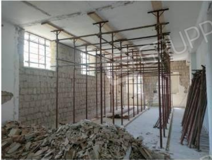
Vista del solaio del secondo impalcato (tipo SAP) oggetto di puntellamento, visto lo stato di avanzato dissesto, propedeutico al successivo rifacimento.
