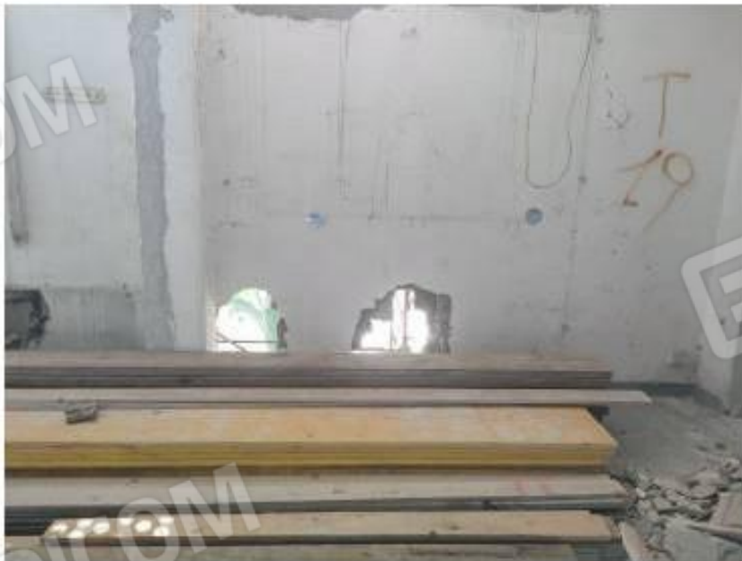
Vista di dettaglio della tompagnatura del primo piano interessata da crollo parziale in proprietà aliena.
