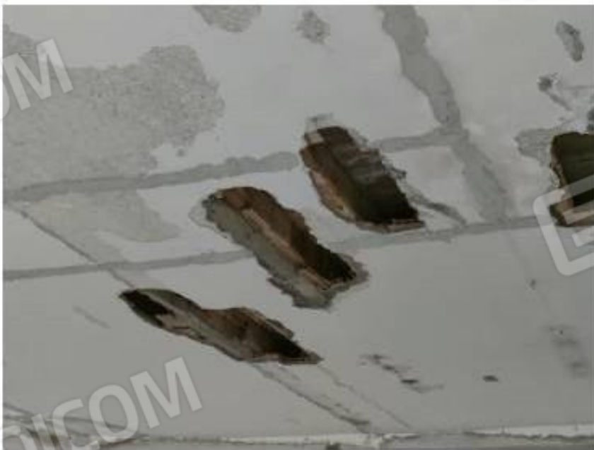
Vista del solaio del secondo impalcato (tipo SAP) in stato di avanzato dissesto.
