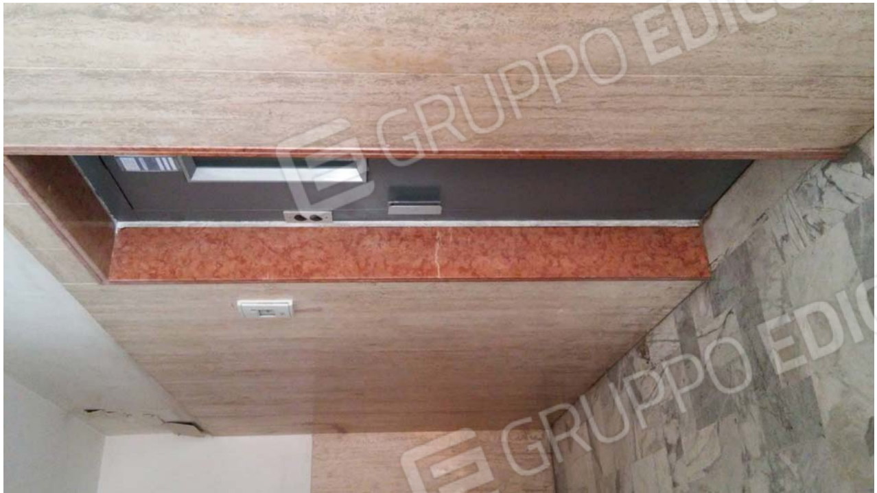
Foto 9 – Ascensore ubicato nell'androne della scala "B" del fabbricato
