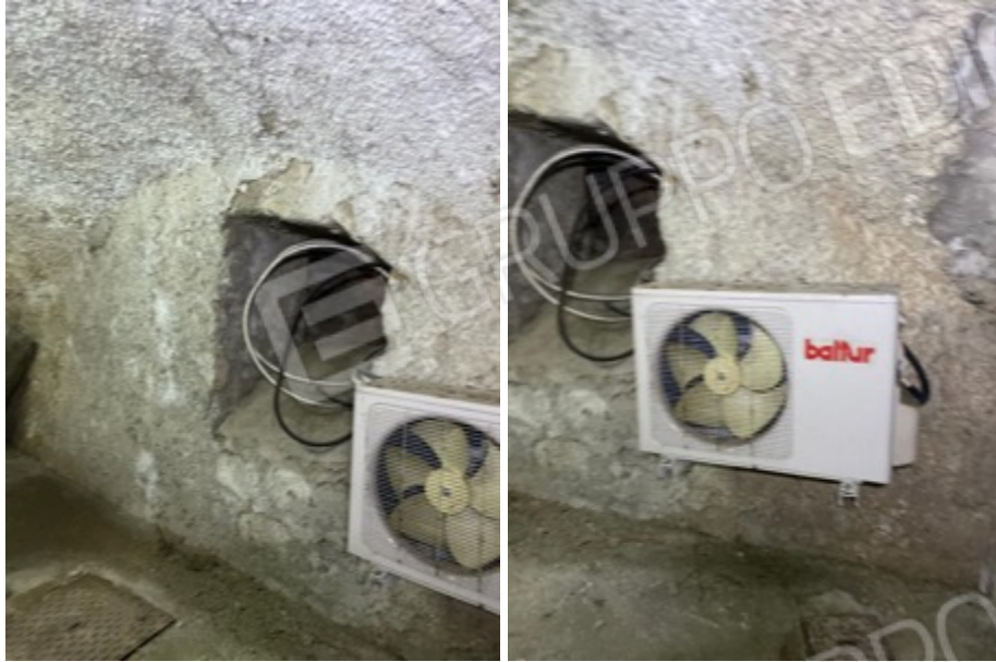
Foto da 39 a 40 : Vista motore area condizionata
