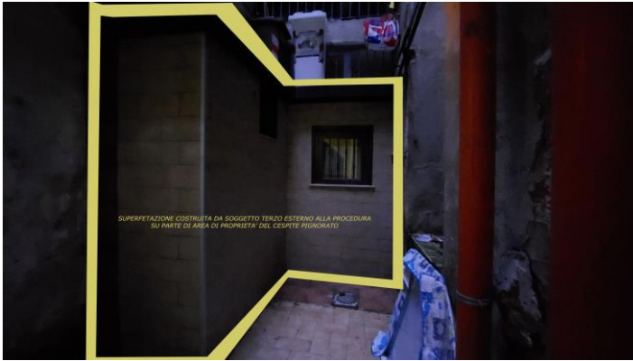
Cortile pertinenziale con presenza superfetazione soggetto terzo
