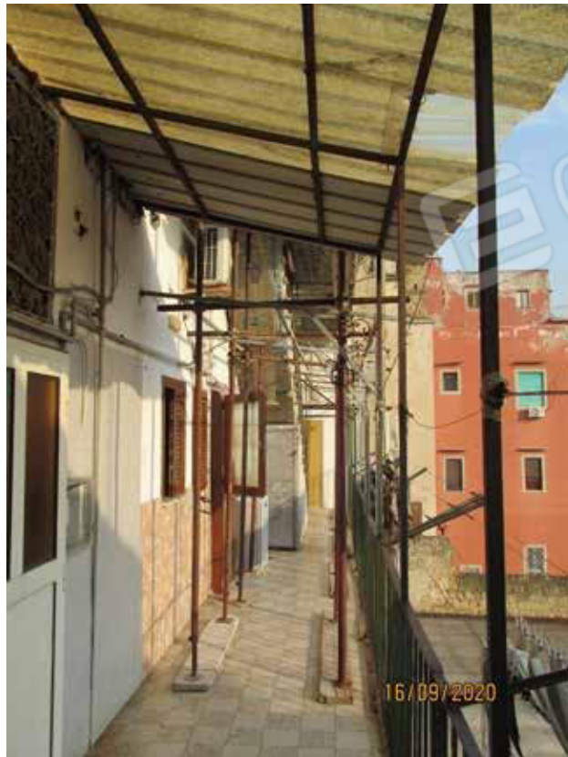
Fotografia 20: Il passetto del secondo piano risulta pavimentato con piastrelle in ceramica smaltata e protetto verso l'esterno da una ringhiera in ferro, inoltre, su di esso risulta installata una puntellatura in ferro a sostegno del passetto del terzo piano.
