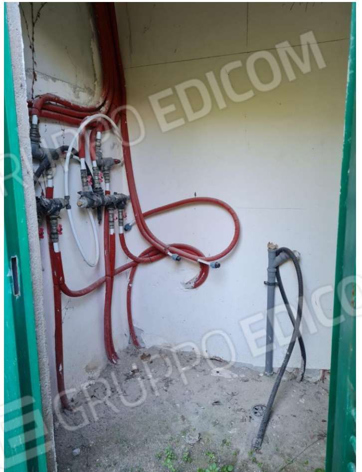
Locale Caldaia (LC)
