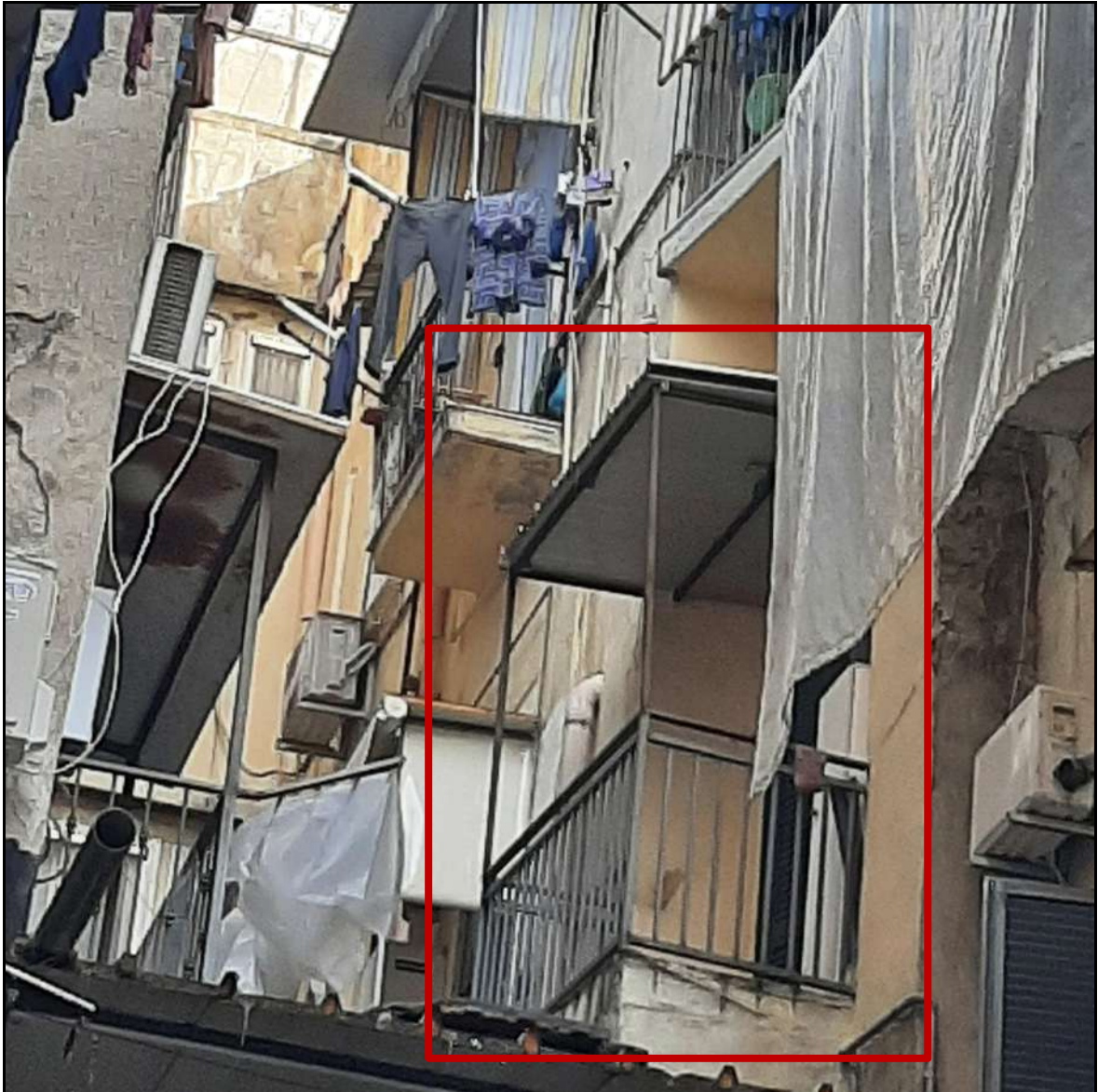
Balcone abusivo del bagno sul retro fabbricato - affaccio su cortile
