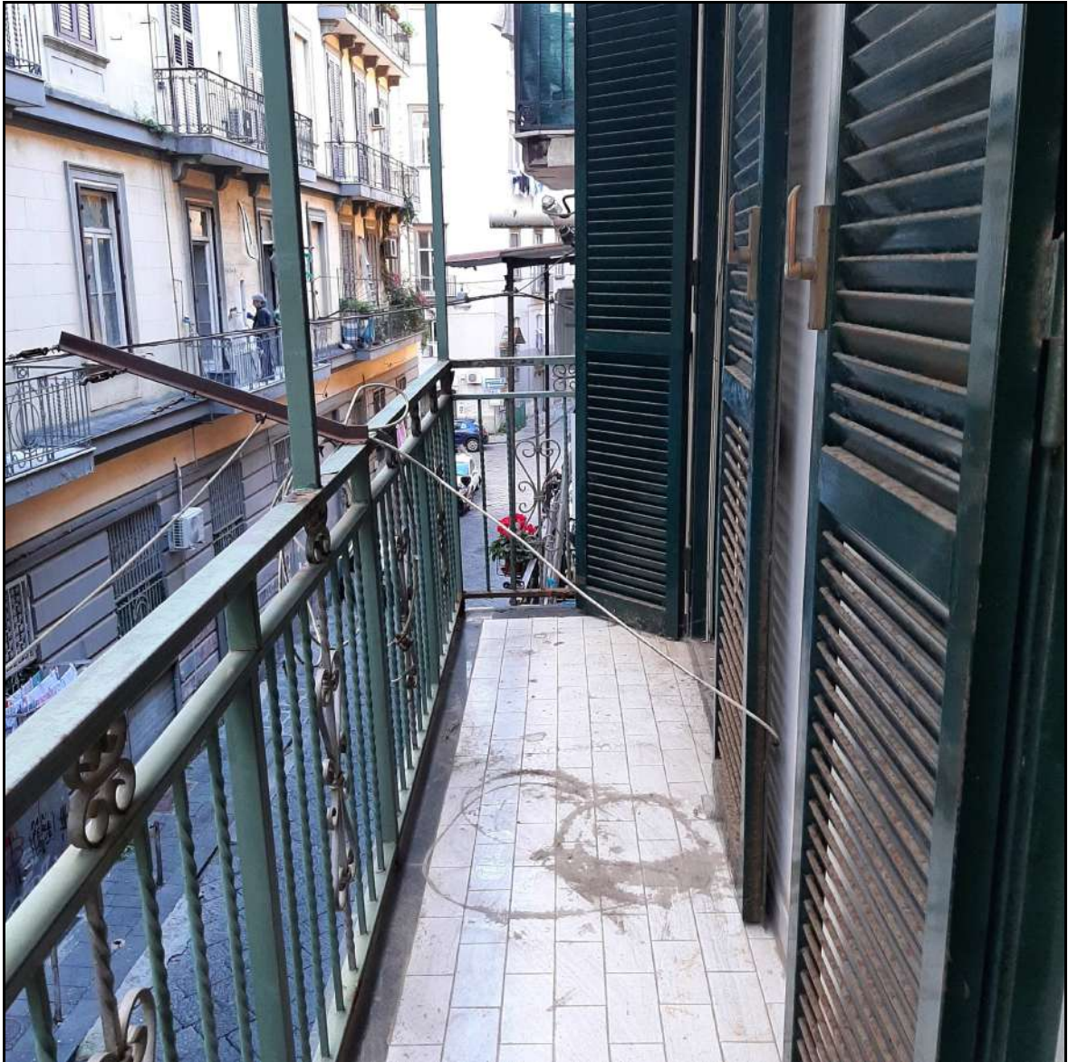
Balcone abusivo affaccio su Via Cardinale Paolo Burali d'Arezzo
