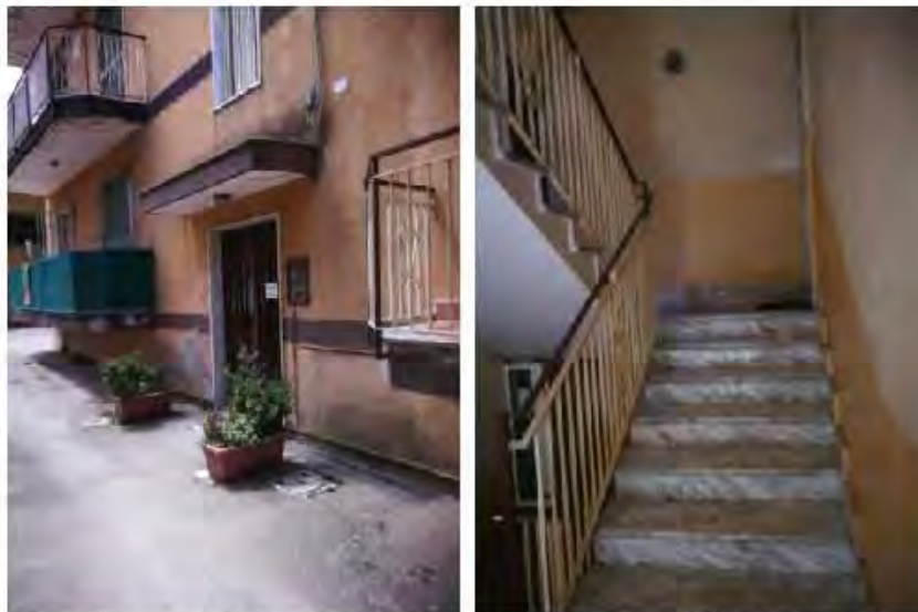
Figg. 31 e 32 – Accesso al vano scala condom. (foto sin.) e vano scala (foto des.) del fab. di via Einstein n. 1
