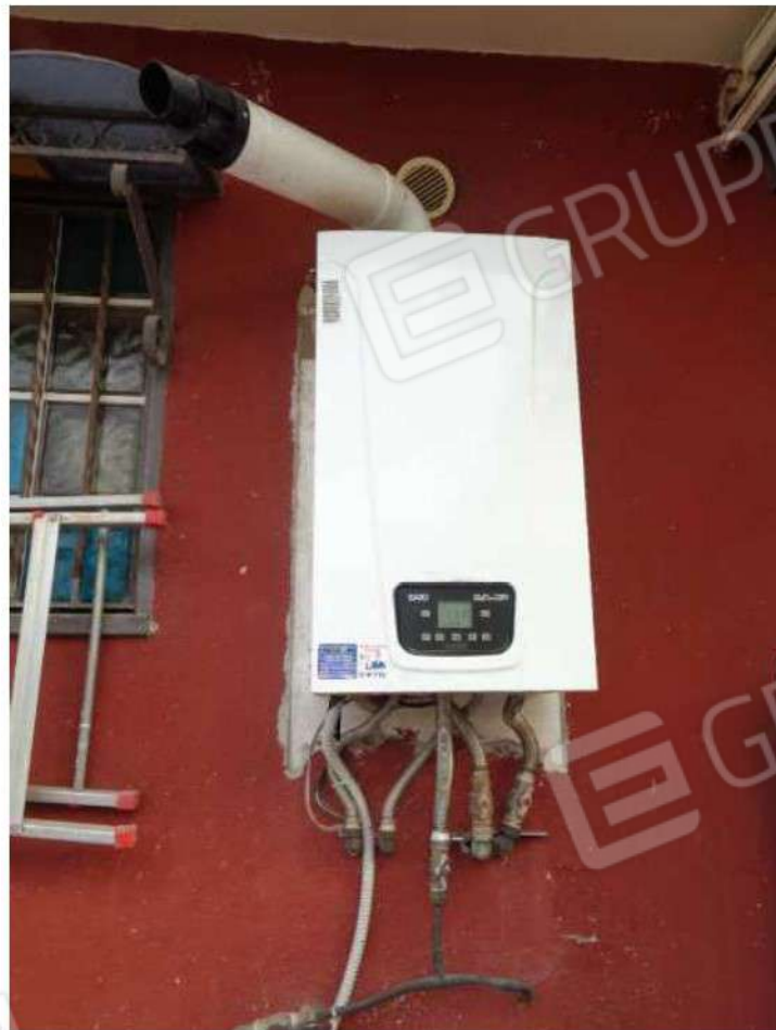
Foto n. 34: • Caldaia impianto autonomo.
