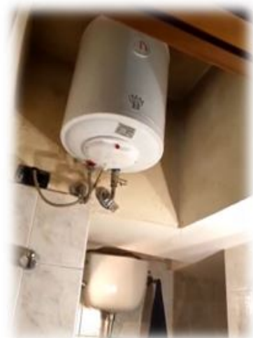
impianto per la produzione di acqua calda
