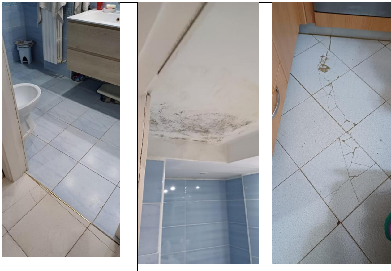
Foto n. 11-13 (wc, danni)-16 (danni generici al pavimento)
