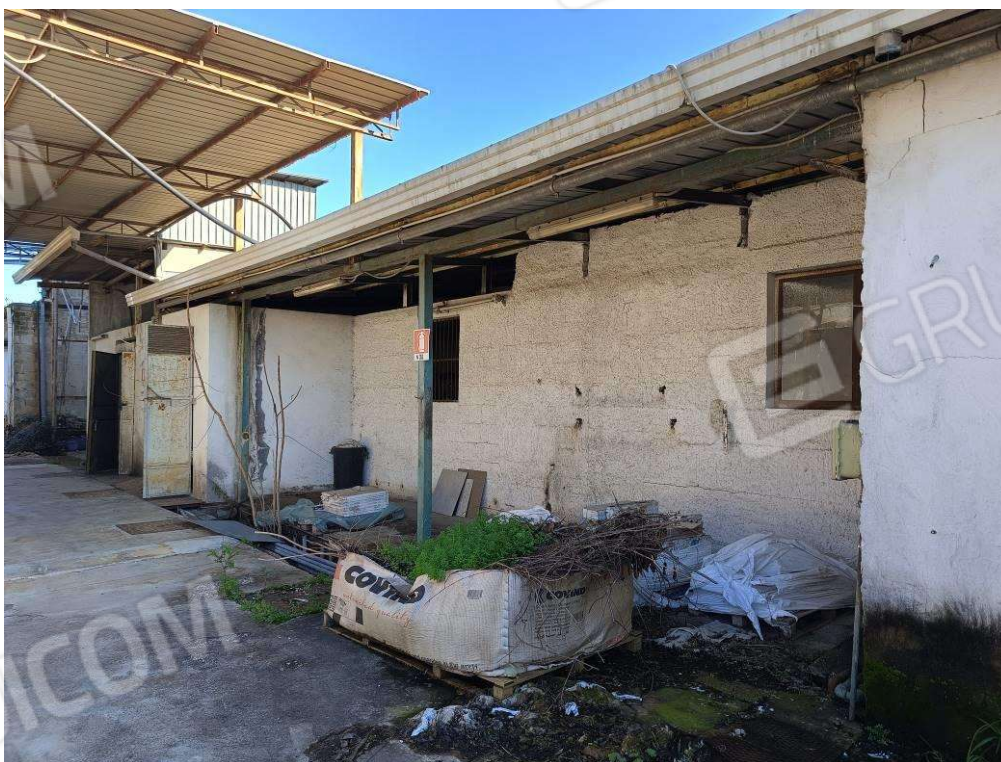
Foro 24 Sub. 6 Edif D1
