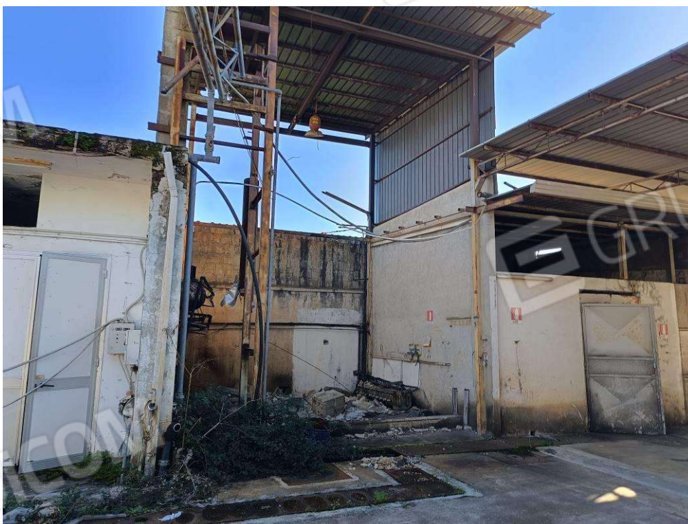
Foro 28 Sub. 6 Edif D1
