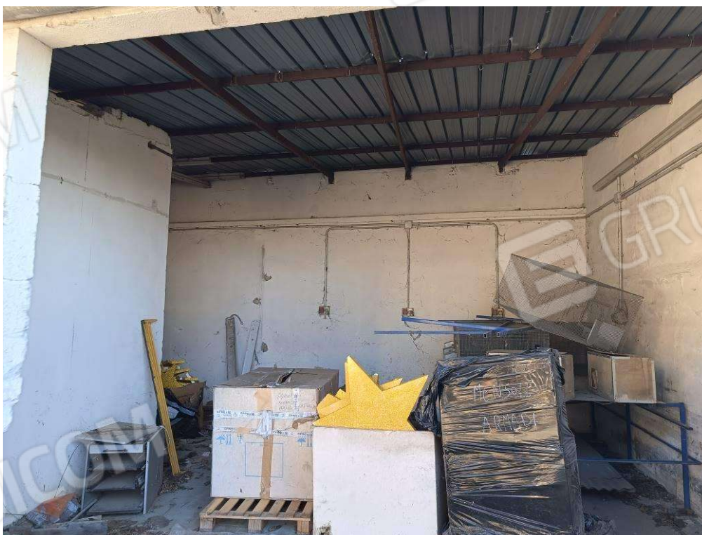
Foro 26 Sub. 6 Edif D1
