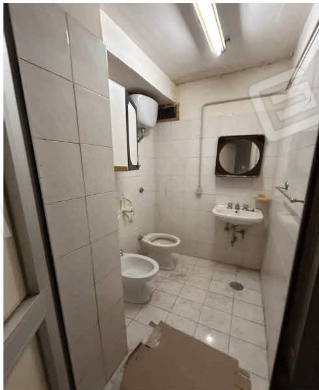
FOTO 16 Locale deposito al PS1 - SUB 101: bagno n°1
