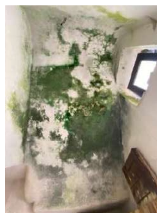
Foto n. 7: Efflorescenze all'intradosso del solaio
