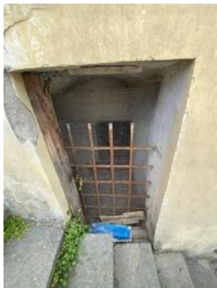
Foto n. 9: Piccolo locale di sgombero ostruito
