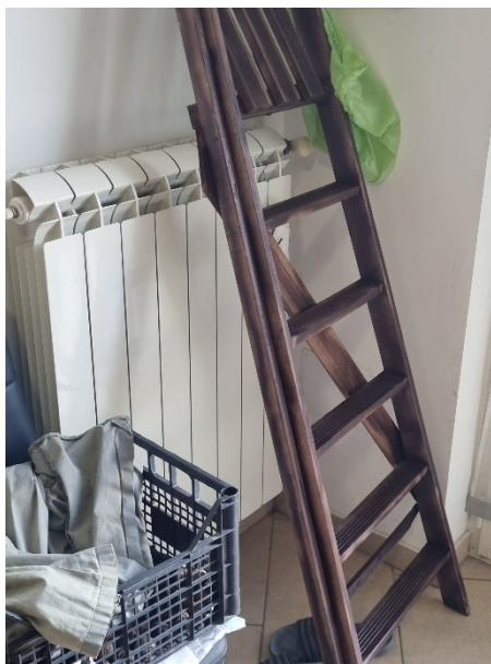
Particolare impianto di riscaldamento
