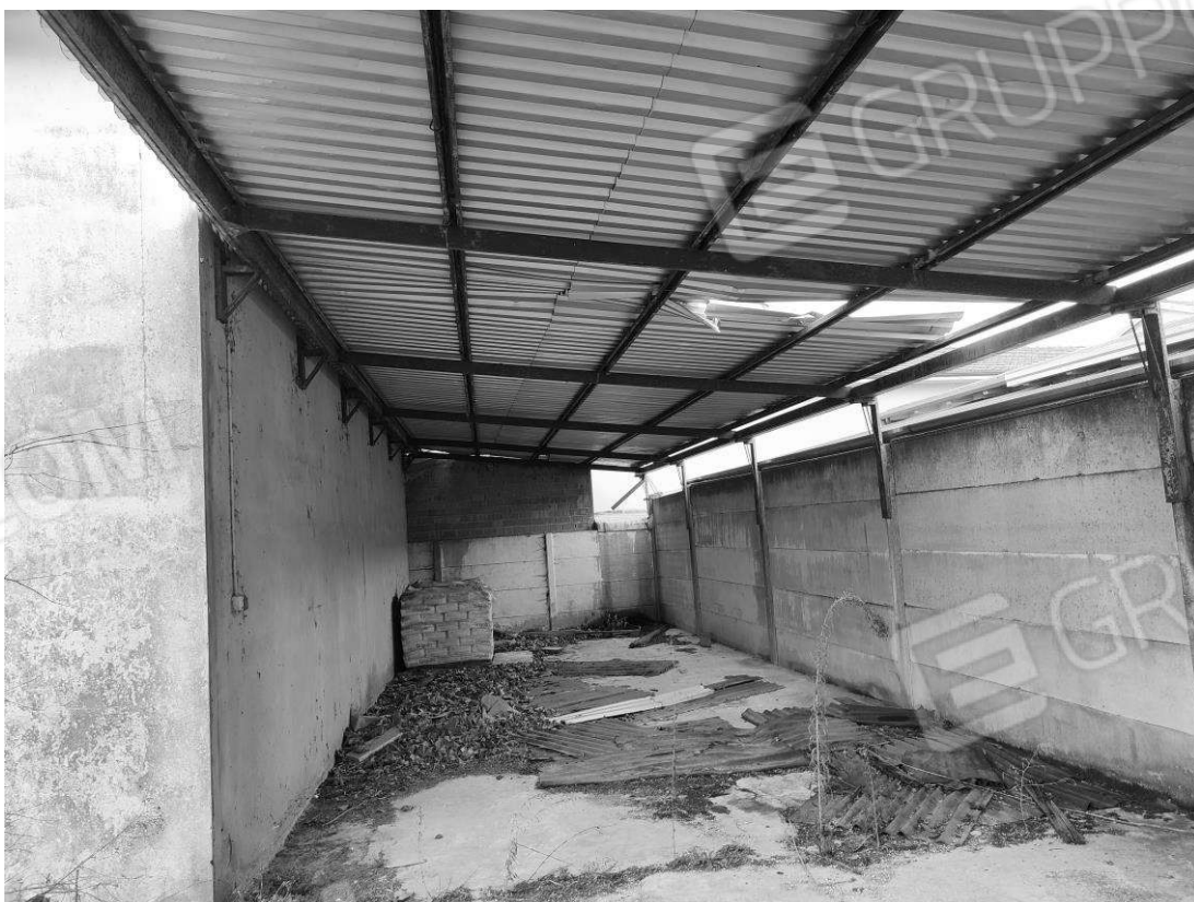
FOTO 14 – tettoia irregolare da rimuovere
