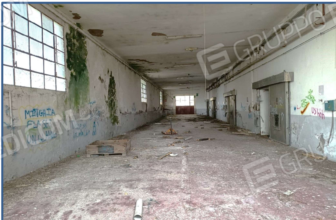
Foto 8 Vista interna in evidente stato di abbandono
