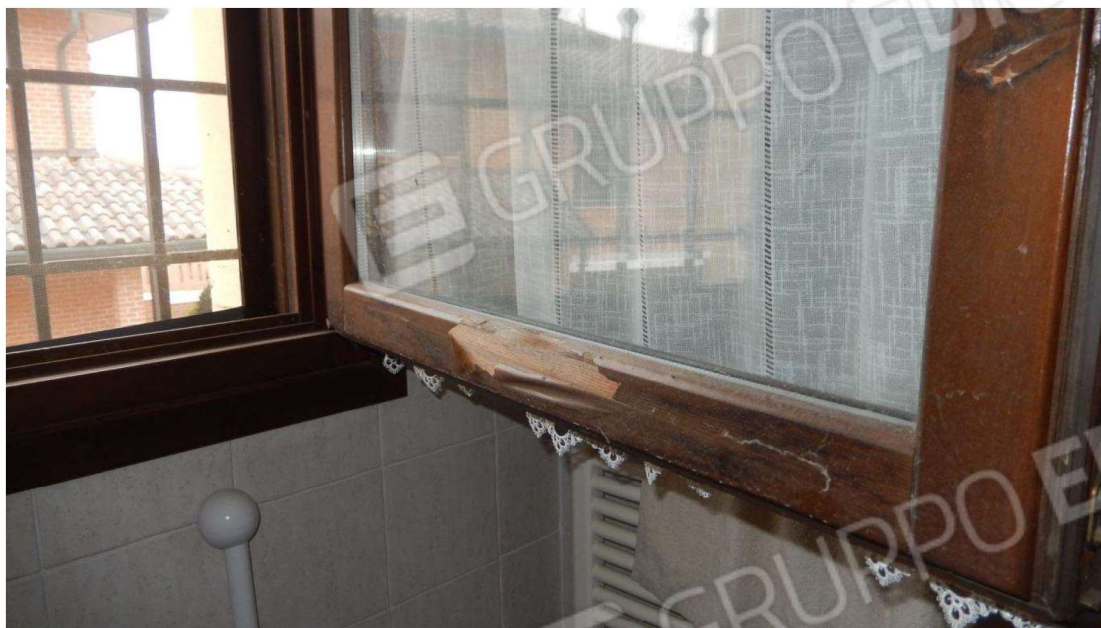
Particolare infissi esterni da manutentare
