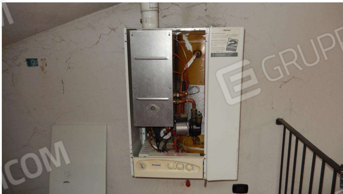
Particolare caldaia in sottotetto
