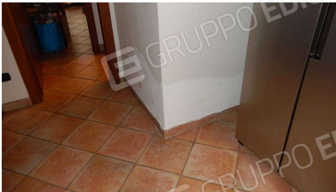
Particolare infiltrazione da doccia del bagno del p.t.
