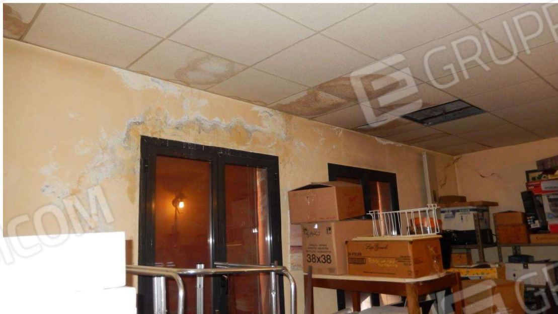
Particolare infiltrazioni acqua da lastrico condominiale soprastante zona ufficio / deposito
