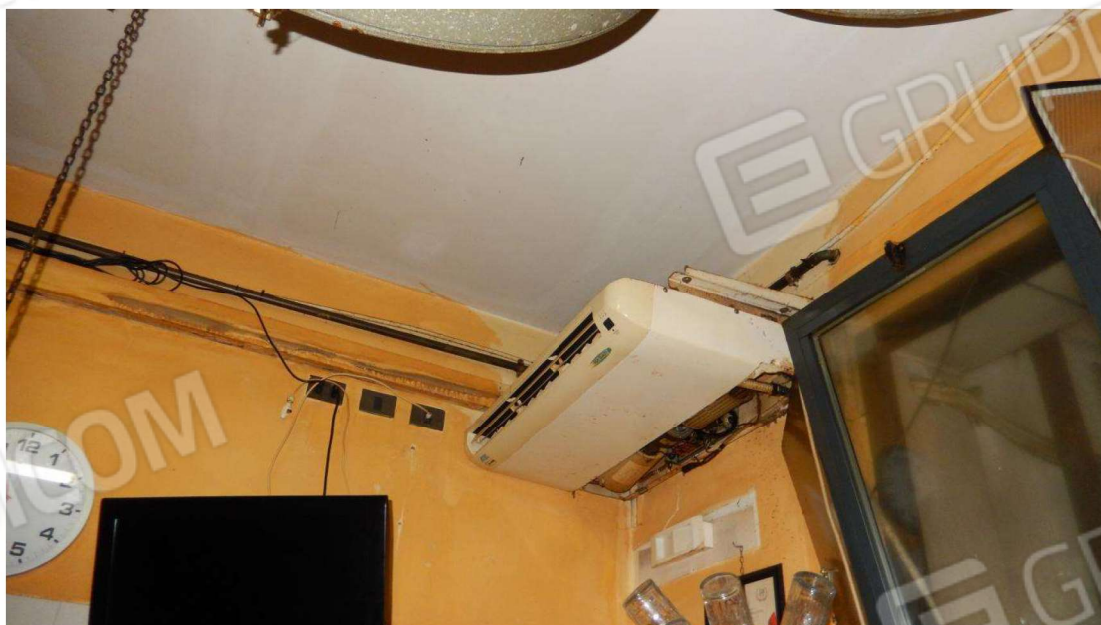
Particolare riscaldamento e raffrescamento aria
