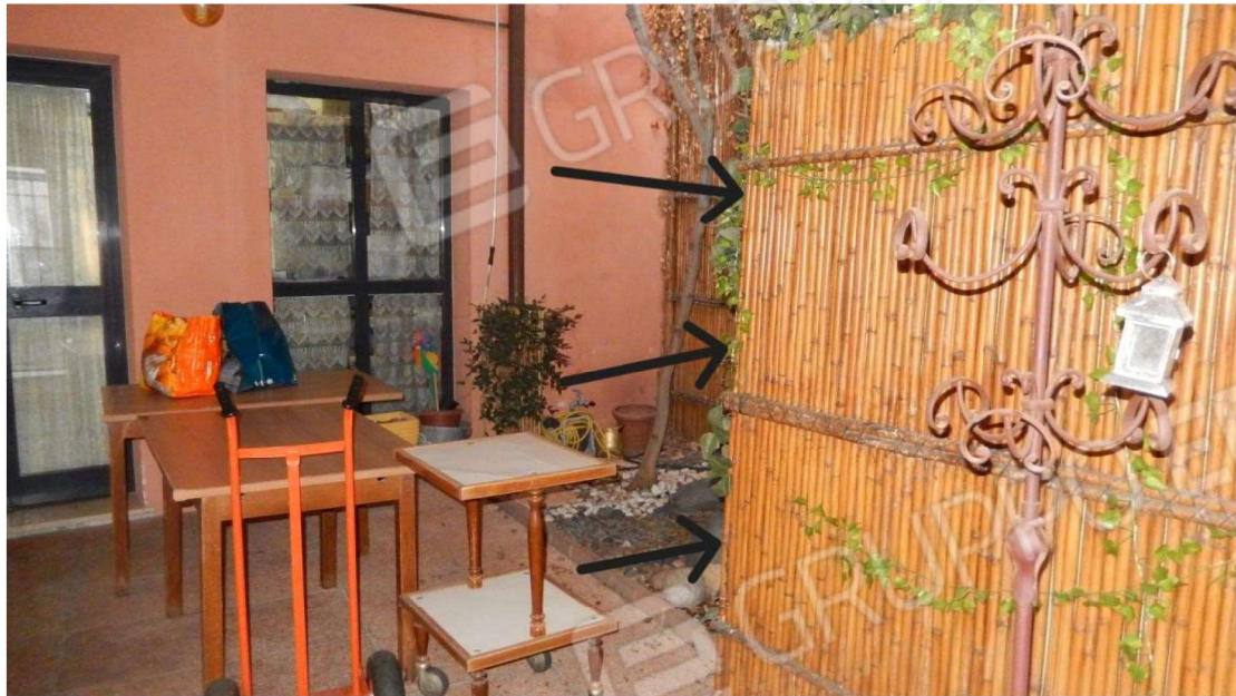
Particolare zona corte adibita a ricovero chiller climatizzazione aria (chiusura con canneto)
