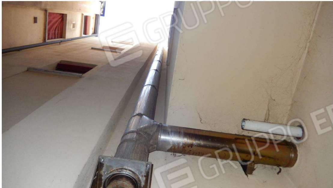
Particolare canne fumarie in pozzo luce interno
