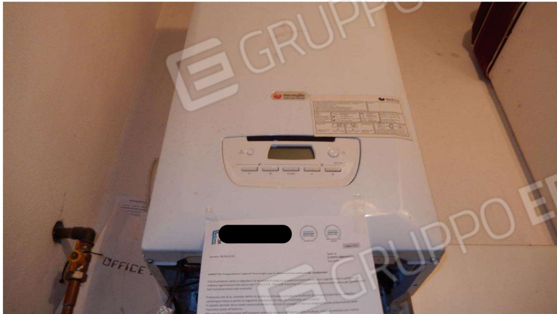
Caldaia in zona spogliatoio dei dipendenti
