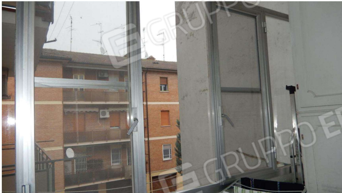
Balcone (sul retro) verandato in difformità e da rimuovere
