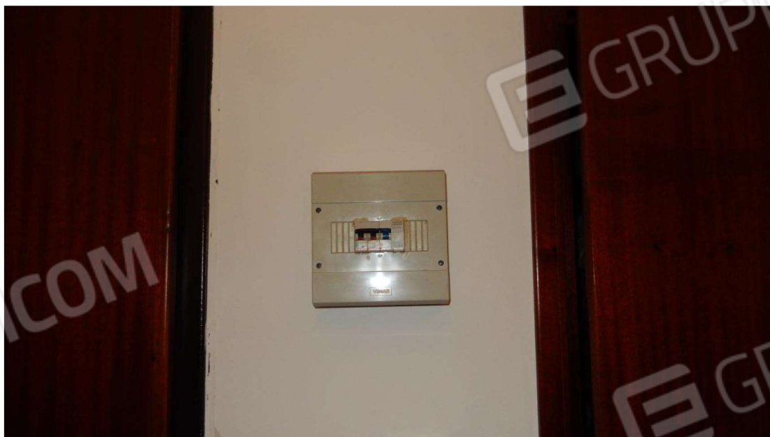
Particolare impianto elettrico
