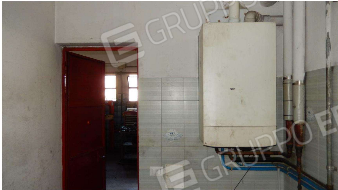
Caldaia posta nel bagno / servizi igienici
