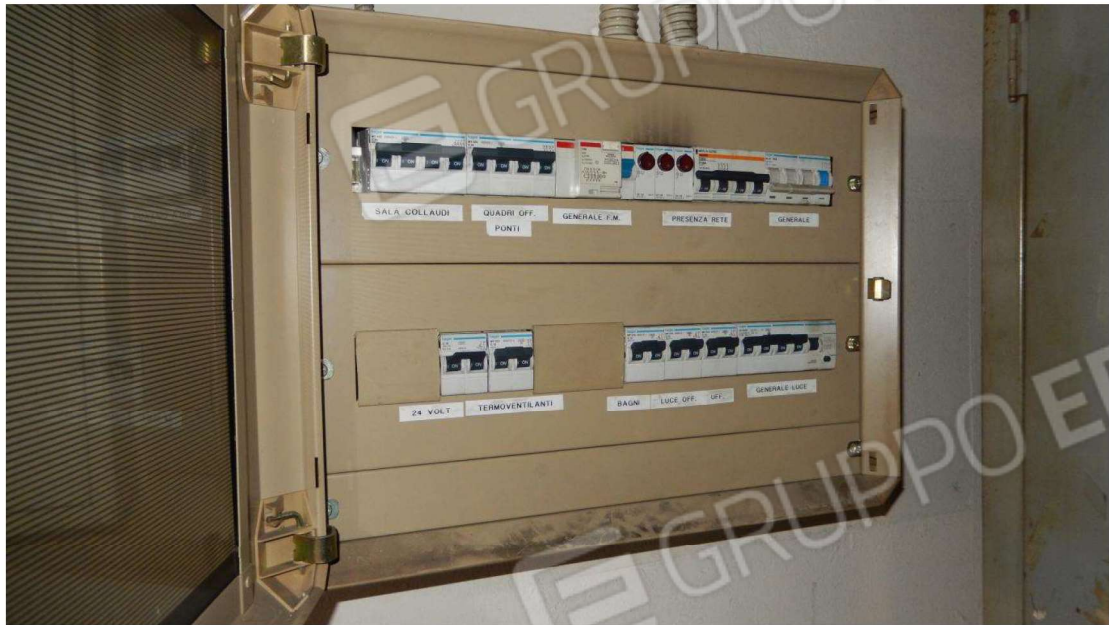
Particolare impianto elettrico: quadro di controllo / sicurezza
