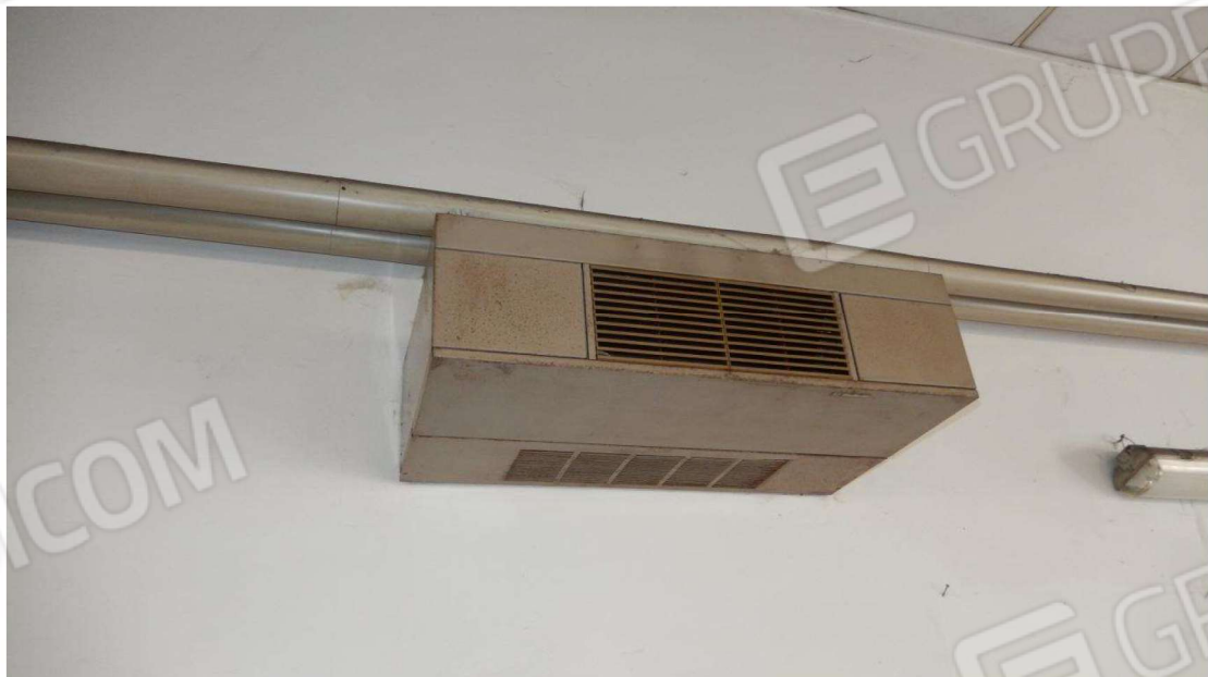
Particolare ventil convettori per il riscaldamento officina (non funzionanti)
