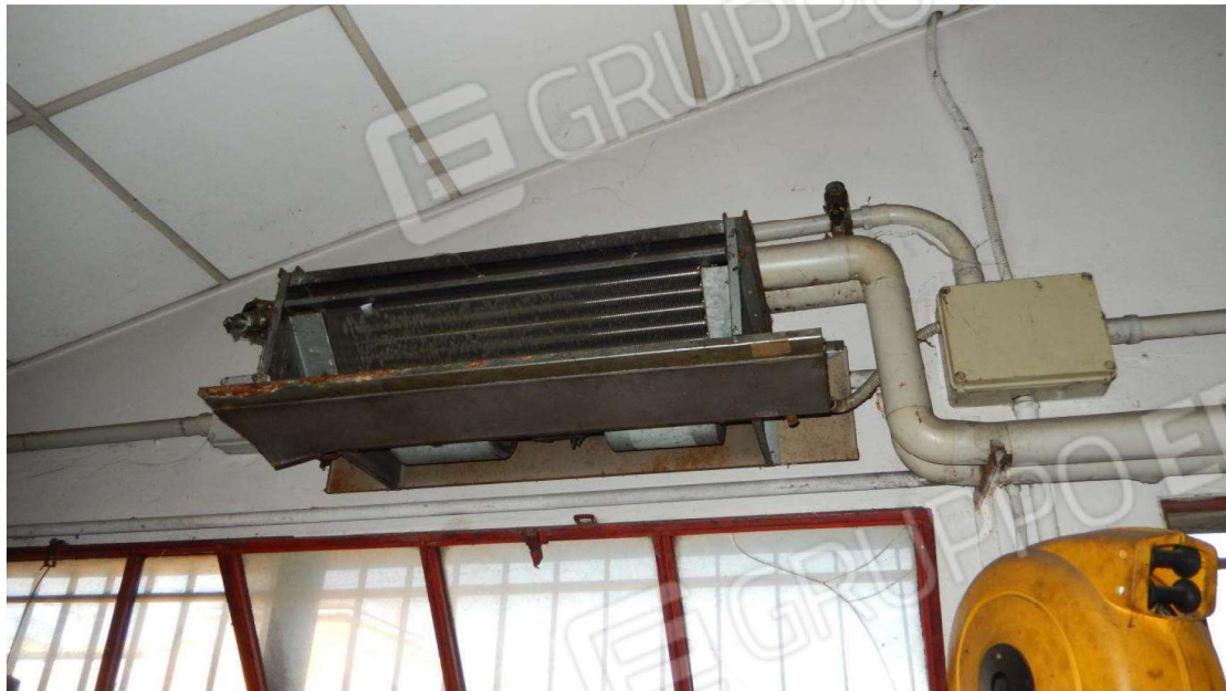
Radiatori ventilati per riscaldamento (non funzionanti)
