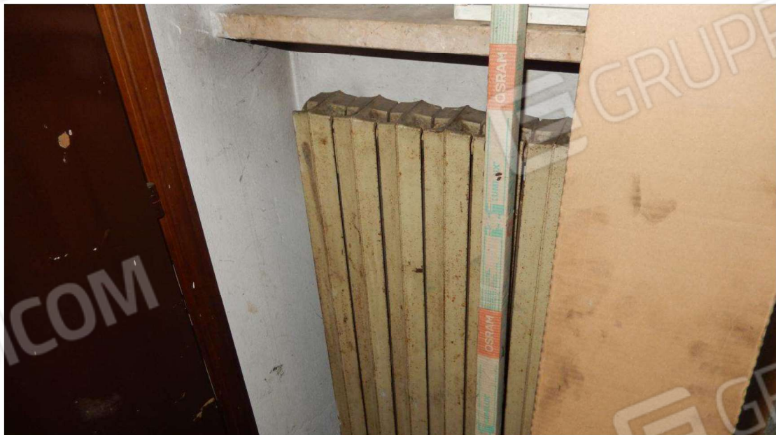
Particolare radiatori bagno e altri ambienti minori
