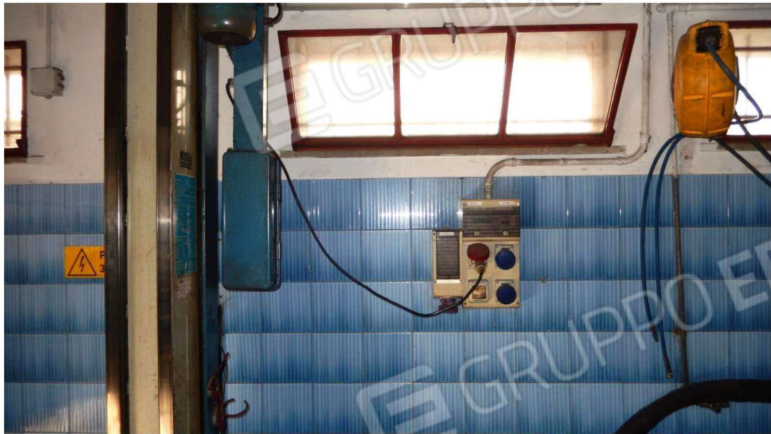
Particolare impianto elettrico con prese a muro
