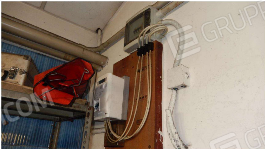
Impianto elettrico con misuratore di consumo
