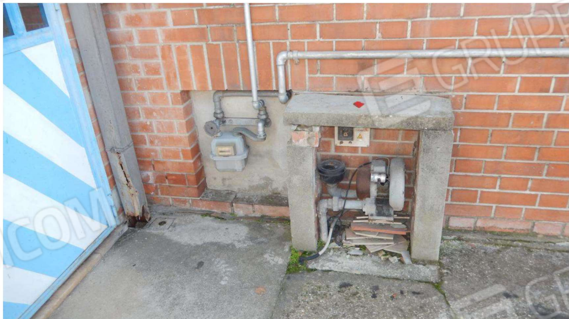
Particolare impianti e misuratore gas
