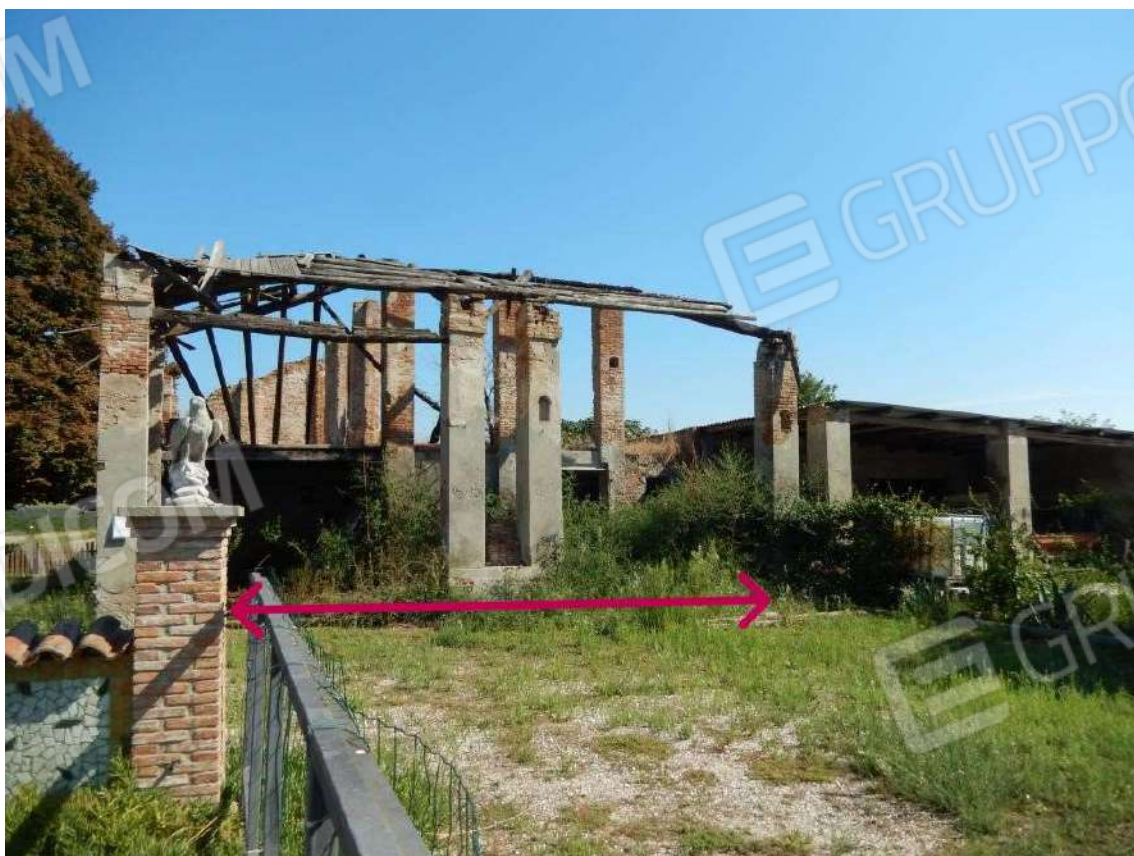
RESTI PORZIONE DI STALLA / FIENILE DIROCCATO (CON PERICOLO DI CROLLO)
