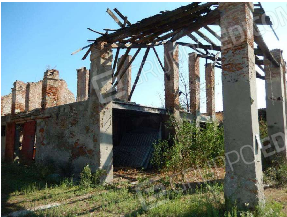
PARTICOLARE RESTI AUTORIMESSA NEL FIENILE / STALLA (INACCESSIBILE)
