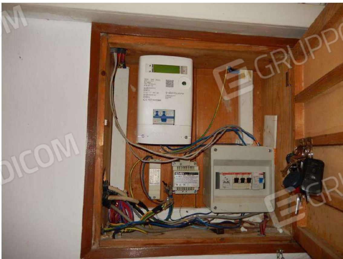
PARTICOLARE IMPIANTO ELETTRICO
