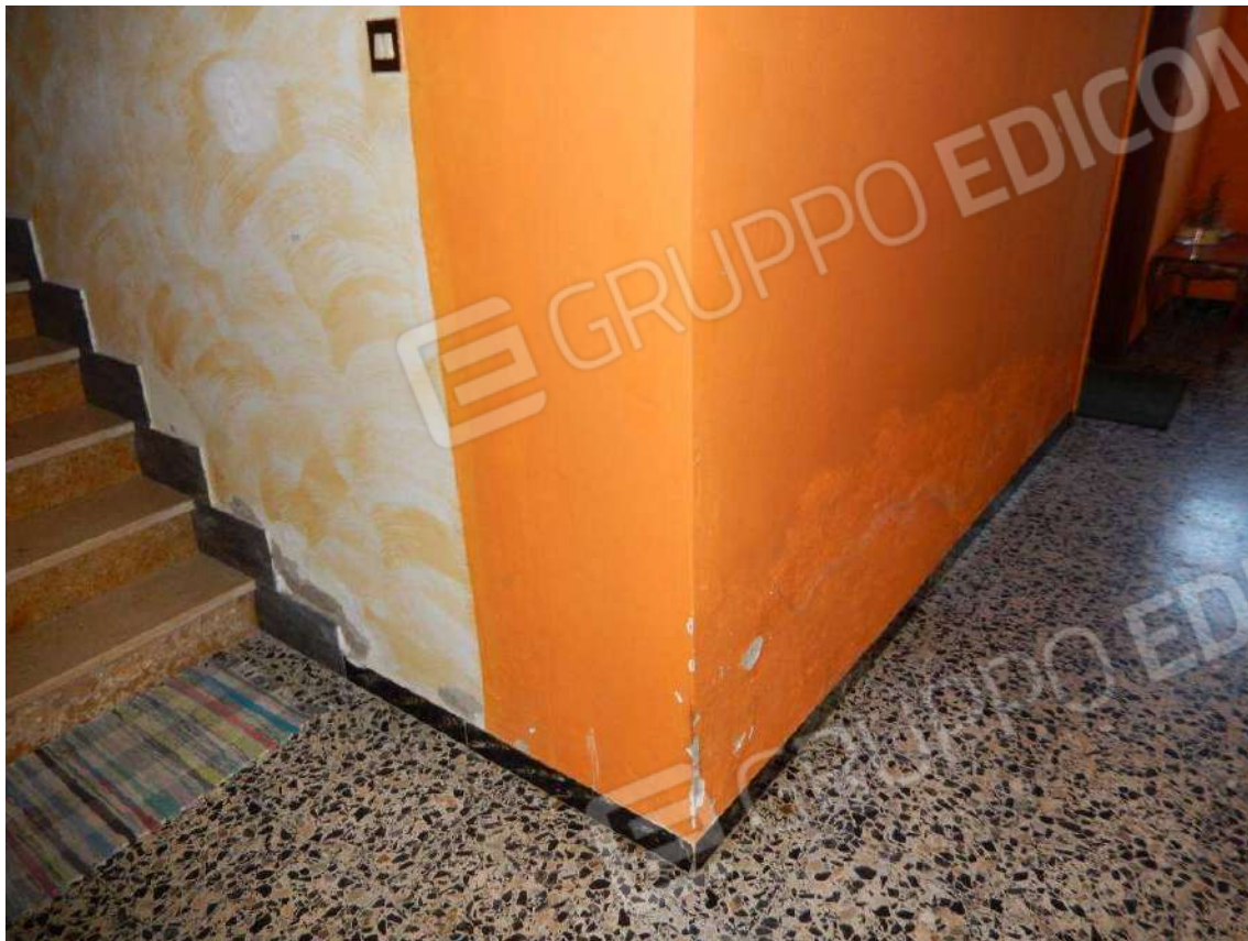
PARTICOLARE INTONACI AMMALORATI DA UMIDITA' AL P.T.
