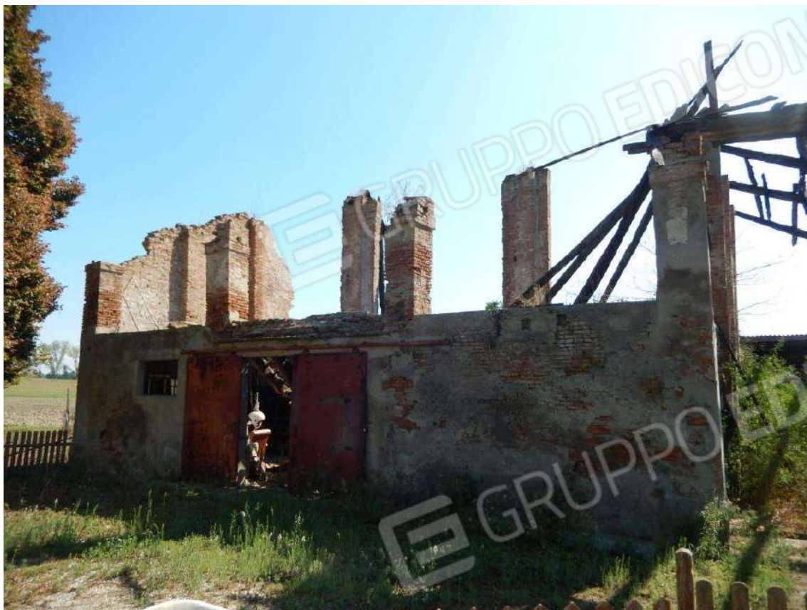
PARTICOLARE STALLA / FIENILE (INACCESSIBILE E DIRUTO PER INCENDIO)
