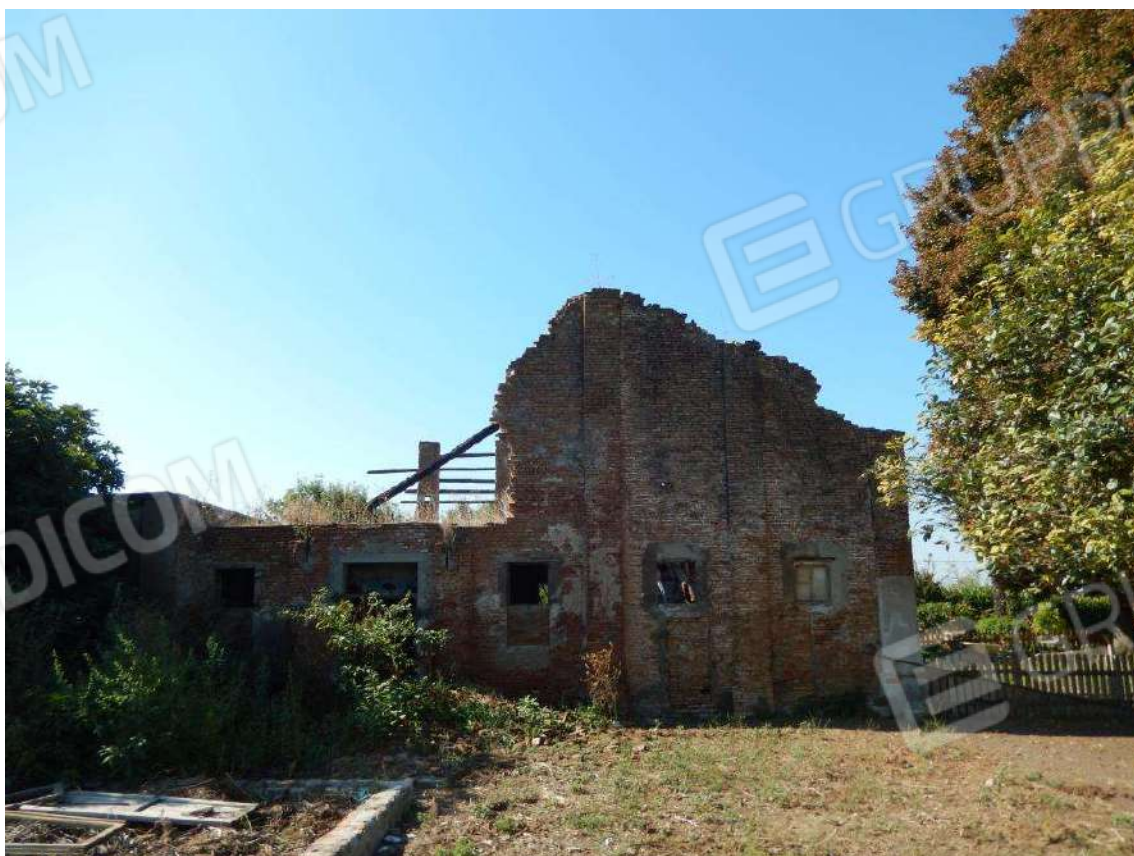
RESTI DEL RUDERE DI STALLA / FIENILE (INACCESSIBILE)
