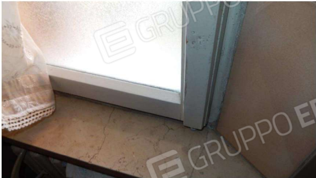
Particolare infissi esterni (vetusti)
