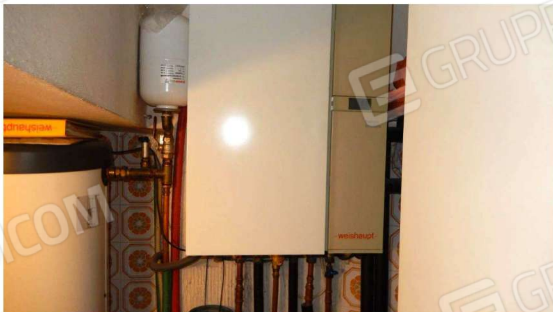
Particolare caldaia villa PT e Dependance
