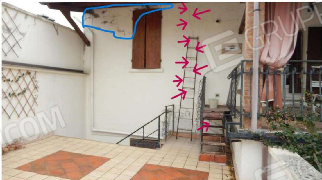
Fessurazione diffusa e passante la muratura e infiltrazione angolo superiore
