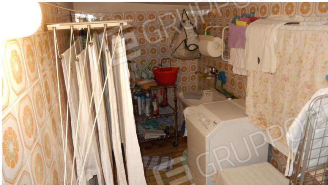
Locale CT e lavanderia
