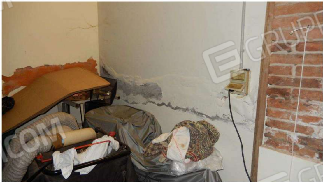
Particolare umidità di risalita capillare nelle murature (quota autorimessa quasi -1 mt da via Piangipane)
