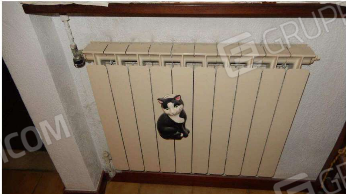
Particolare riscaldamento (vetusto)
