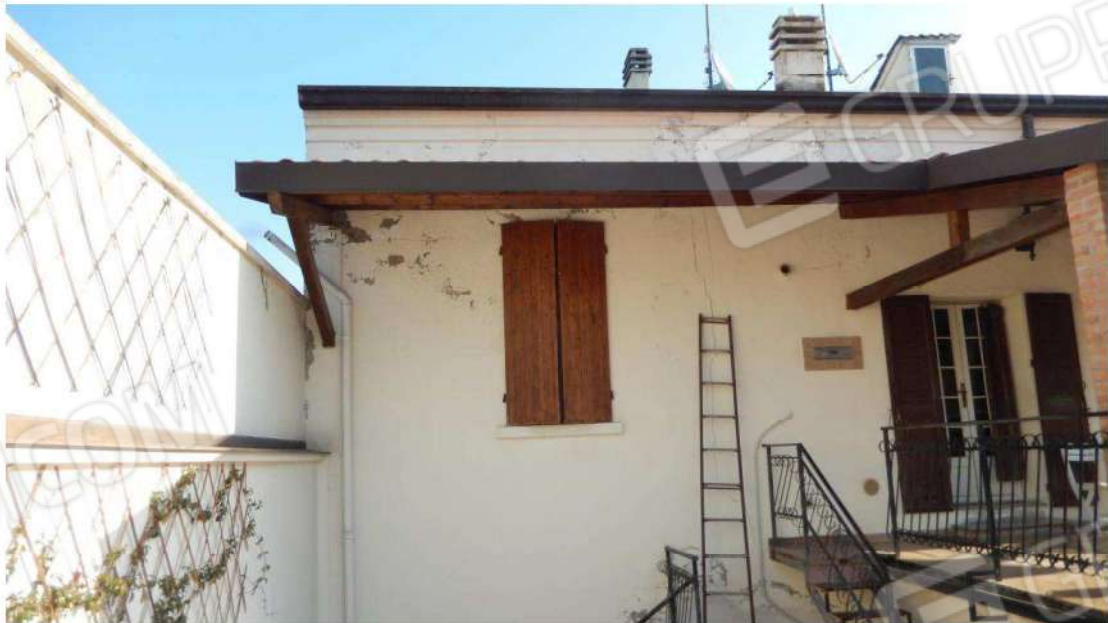
Particolare pensiline / tettoie difformi da rimuovere
