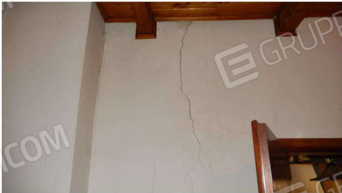
Particolare fessurazione (una delle tante presenti...)
