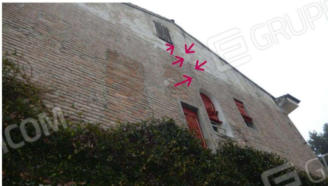
Fessurazione diffusa e passante la muratura, prospetto est (da luce a luce)
