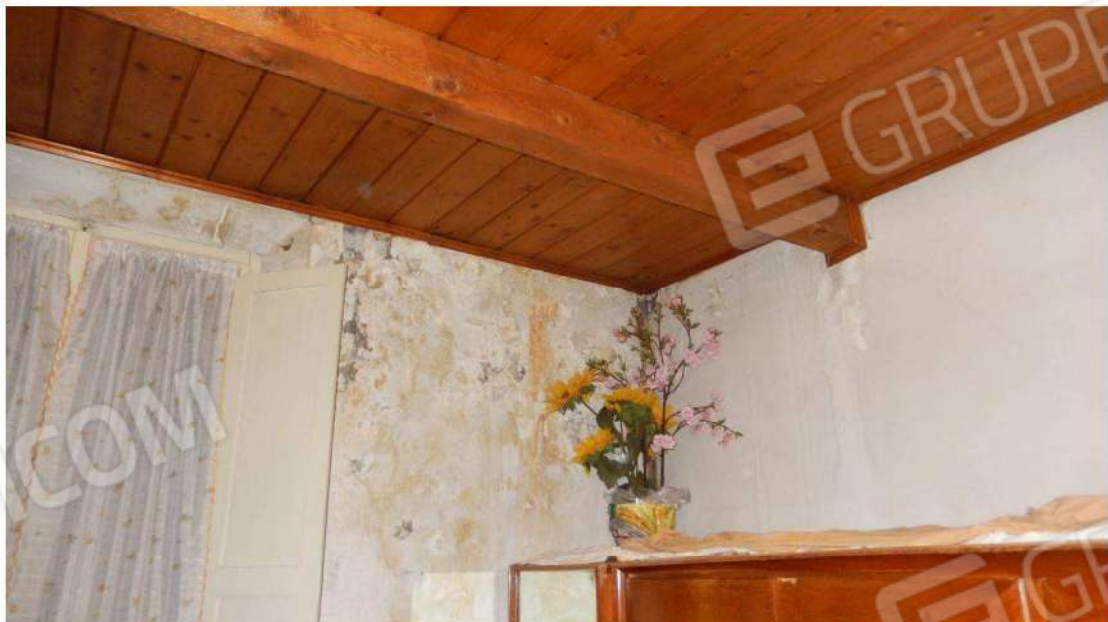
Particolare controsoffittatura e infiltrazioni da coperto / gronda
