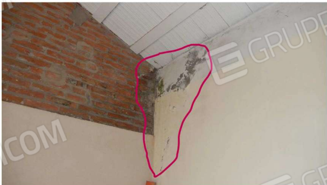
Danni da infiltrazione
