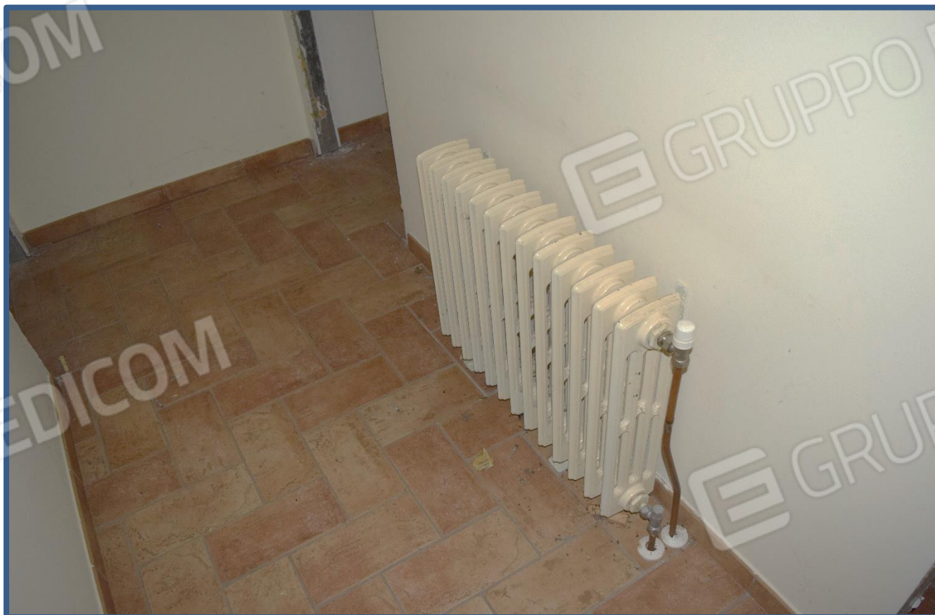
Foto 12 – Pavimentazione e sistema radiante
