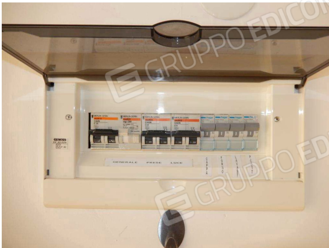
PARTICOLARE IMPIANTO ELETTRICO
