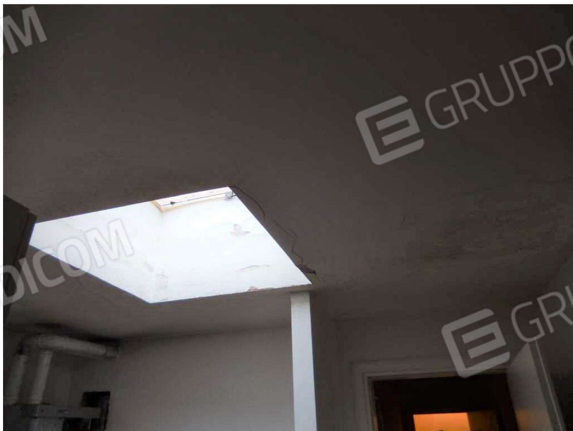
PARTICOLARE INFILTRAZIONI DI ACQUE METEORICHE DA COPERTURA PIANA SU LAVANDERIA
