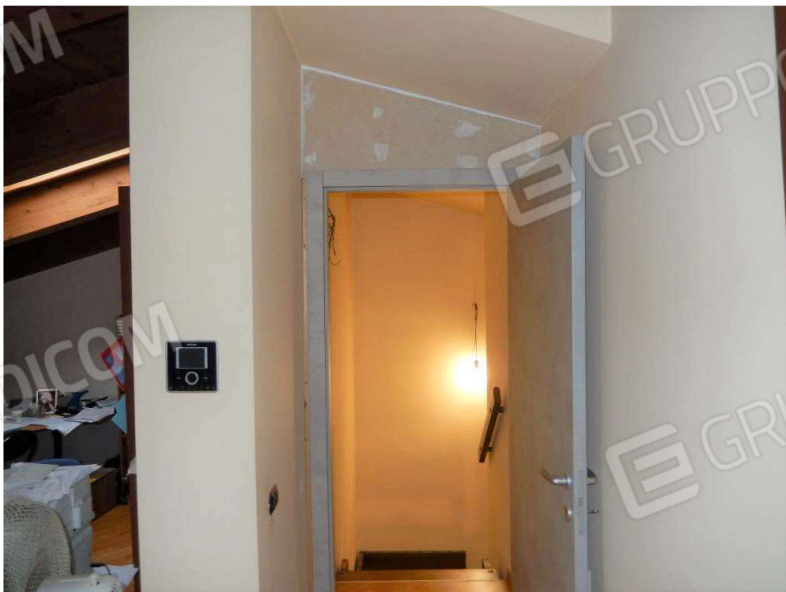
ARRIVO SCALA AL SOTTOTETTO (REALIZZAZIONE DI CHIUSURA IN DIFFORMITÀ EDILIZIA)
