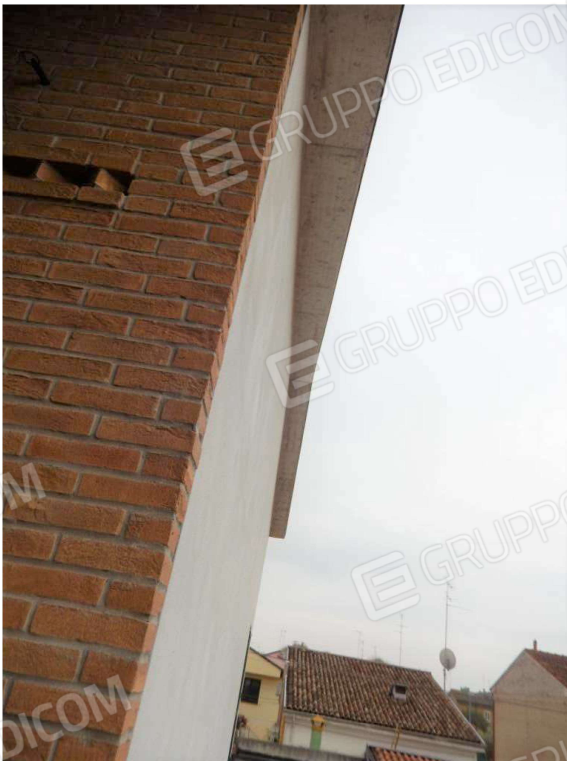
AGGETTO E STILICIDIO DEL CORNICE TETTO, SU PROPRIETA' ADIACENTE (SUB 1 MAPP. 95) DI TERZI ESTRANEA ALLA VENDITA
