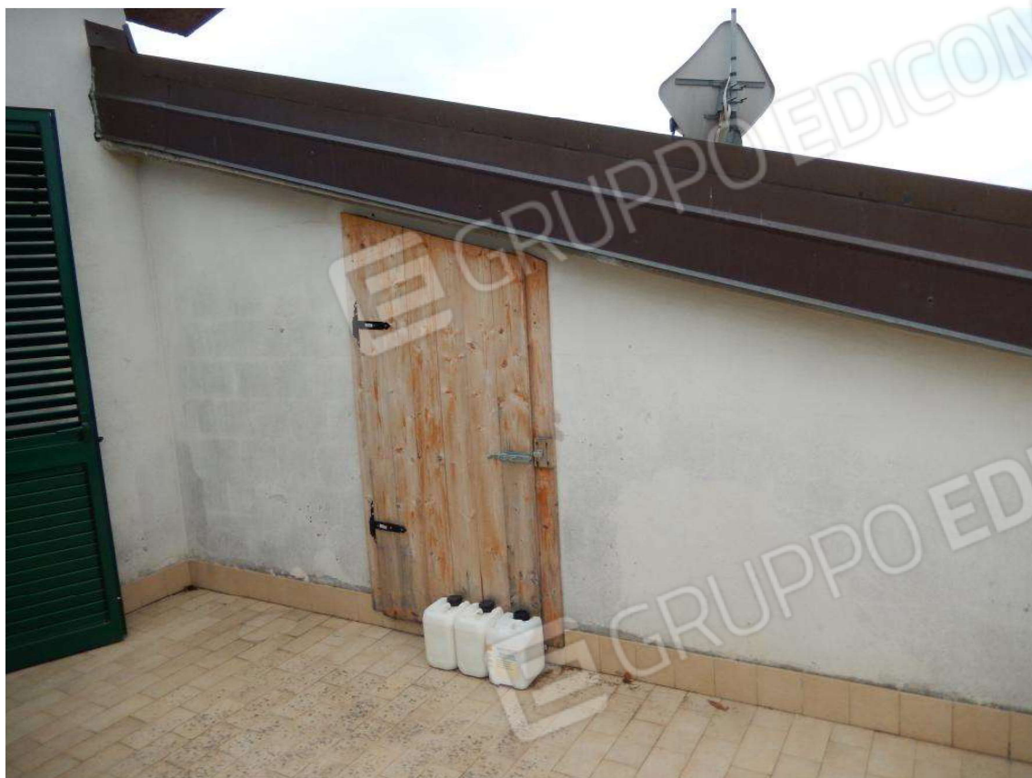
PARTICOLARE DI ACCESSO A VUOTO TECNICO DEL SOTTOETTO (REALIZZAZIONE IN DIFFORMITA' EDILIZIA)
