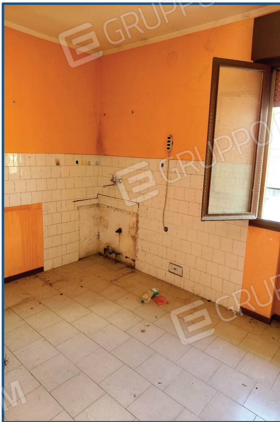
Foto 4 – vano ex cucina
