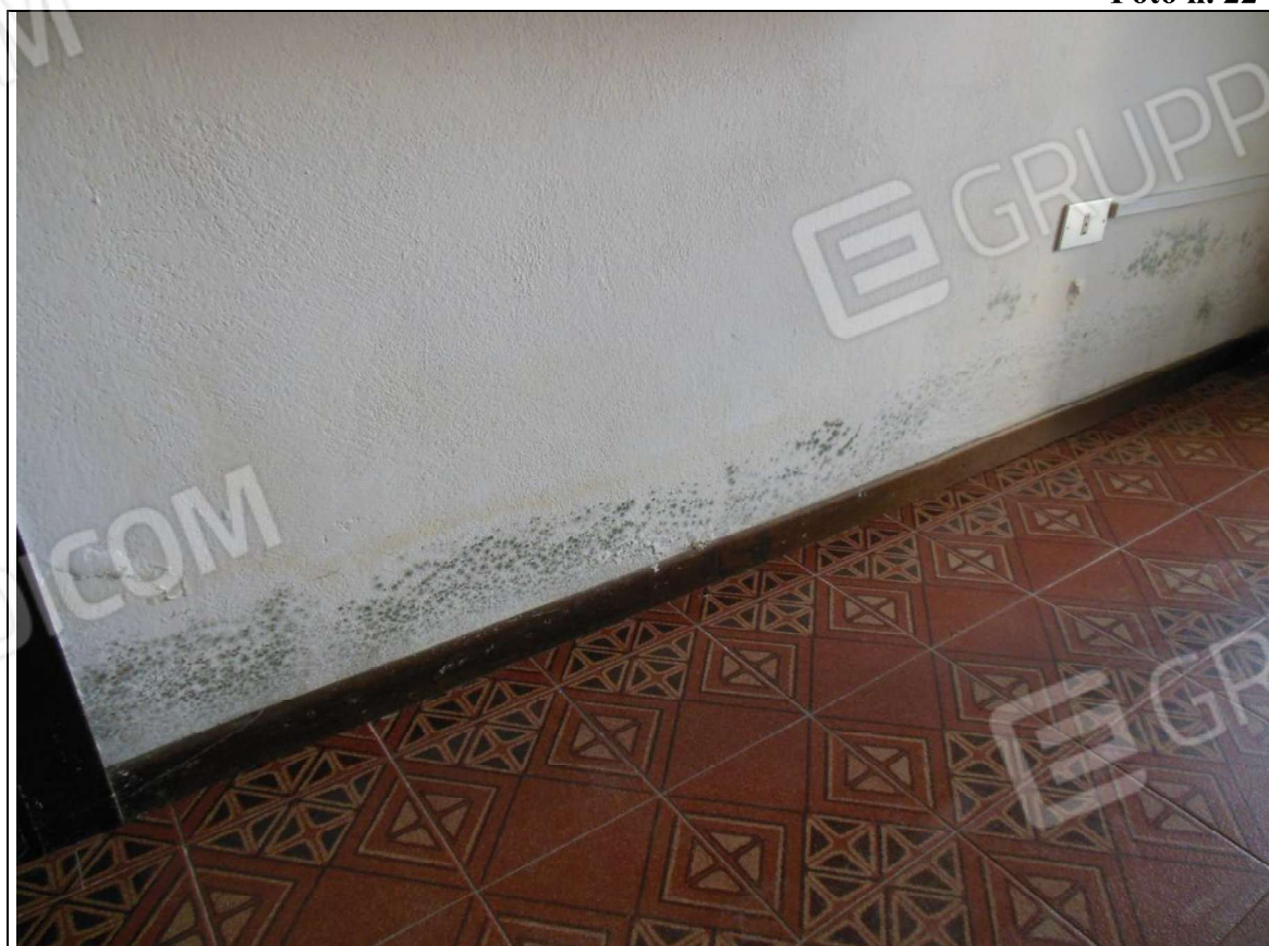
PRESENZA MUFFE SU TRAMEZZA TRA CAMERA LETTO E BAGNO
