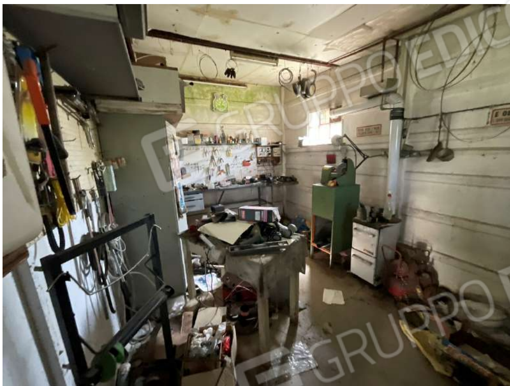
Vano ripostiglio da ripristinare in autorimessa
