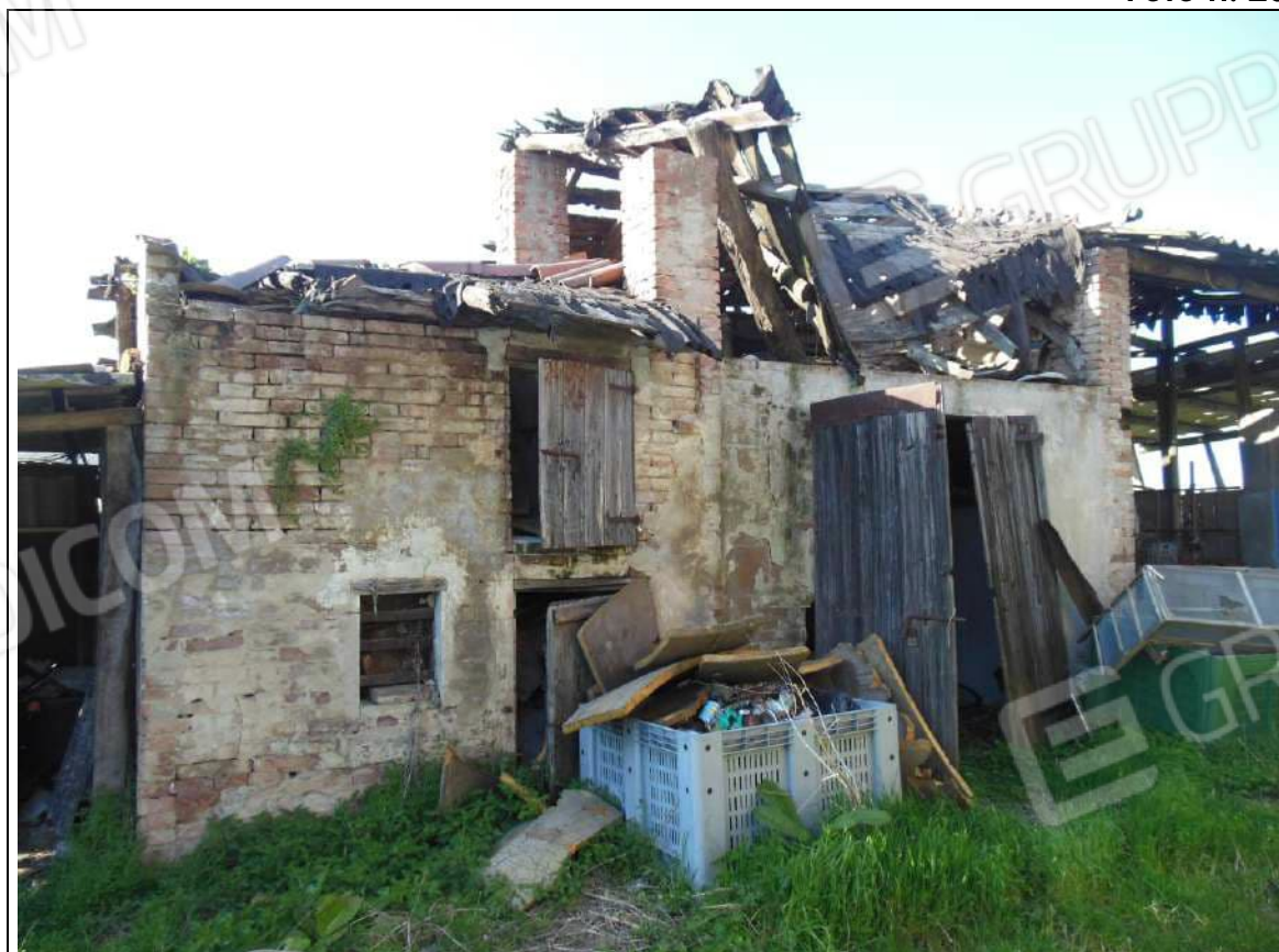
MAGAZZINO-PROSERVIZIO MAPP. 21 SUB 3 (CON COPERTURA CROLLATA)
