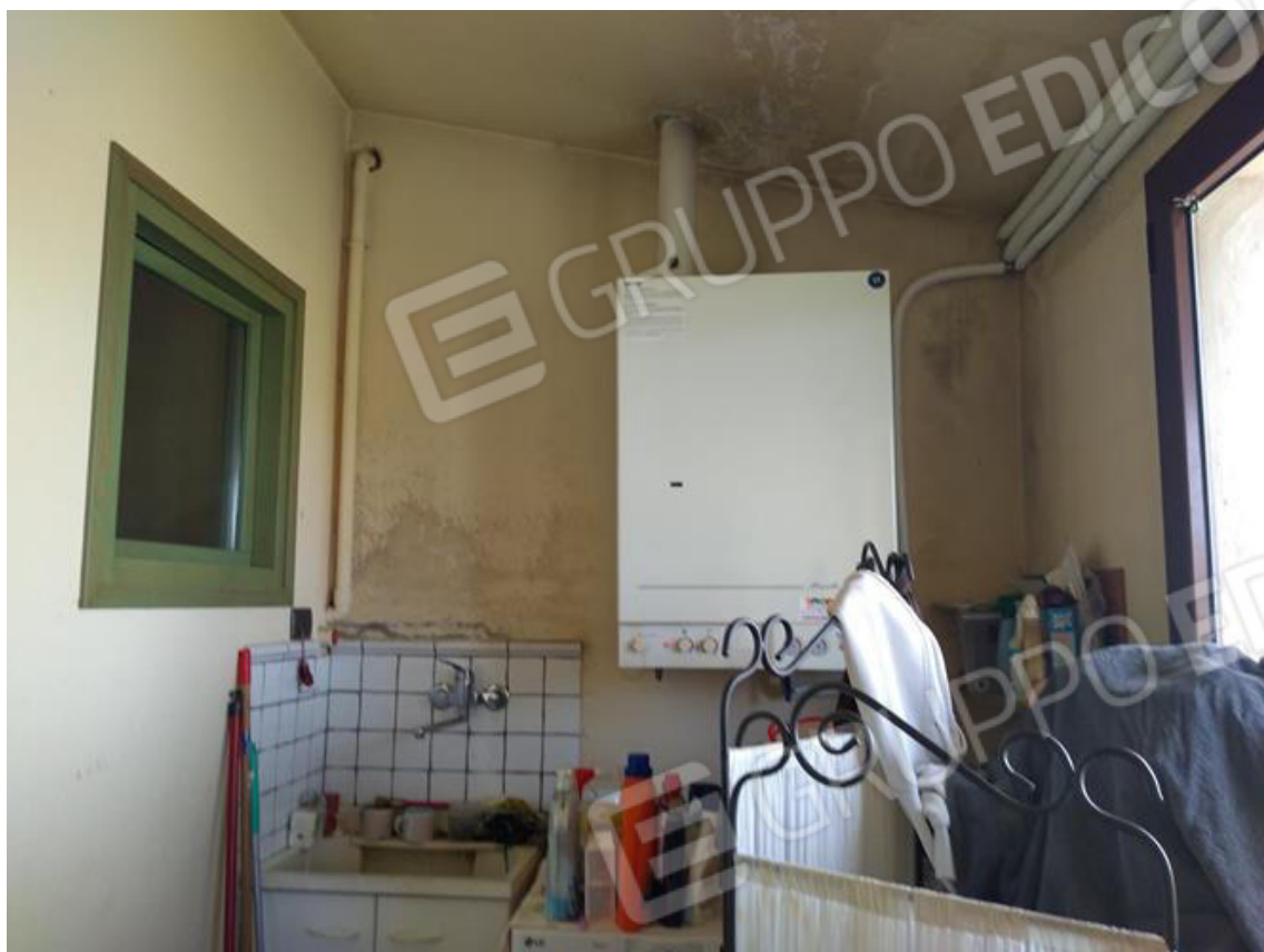
FOTO 10. Piano terra: la lavanderia/centrale termica
