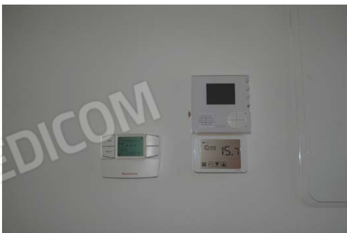
foto n.103 – termostato posto nel corridoio dell'appartamento, in prossimità della porta di ingresso
