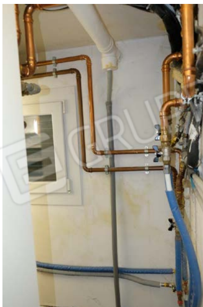
foto n.77-78 – veduta caldaia e delle tubature dell’impianto di riscaldamento poste nel sottoscala
