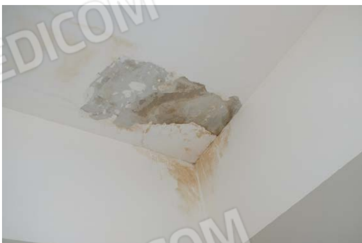
foto n.64-65 – veduta e particolare del solaio dove era ubicata la cappa di aspirazione del piano cottura
