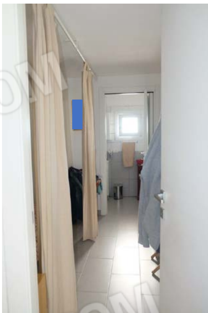
foto n.84– veduta dell'autorimessa utilizzata, impropriamente, come appartamento
