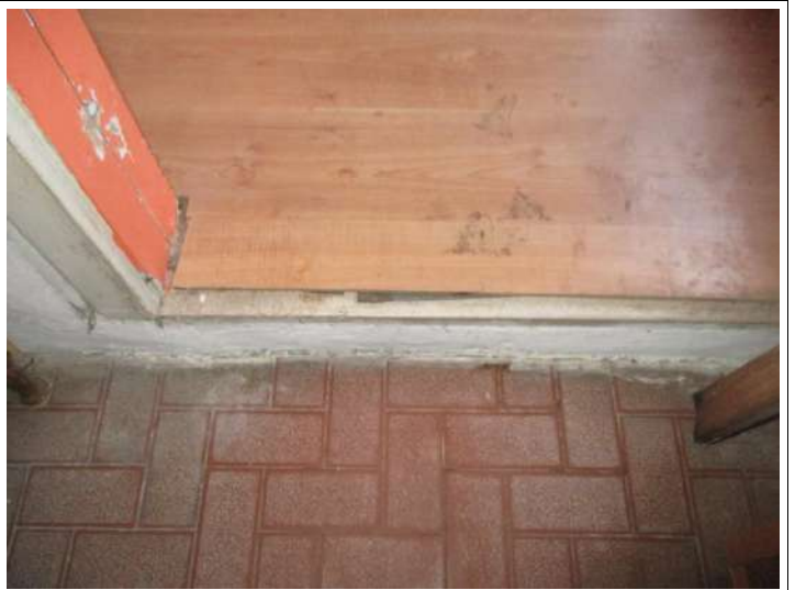
Particolare della diversa tipologia di pavimentazione tra i due appartamenti.
