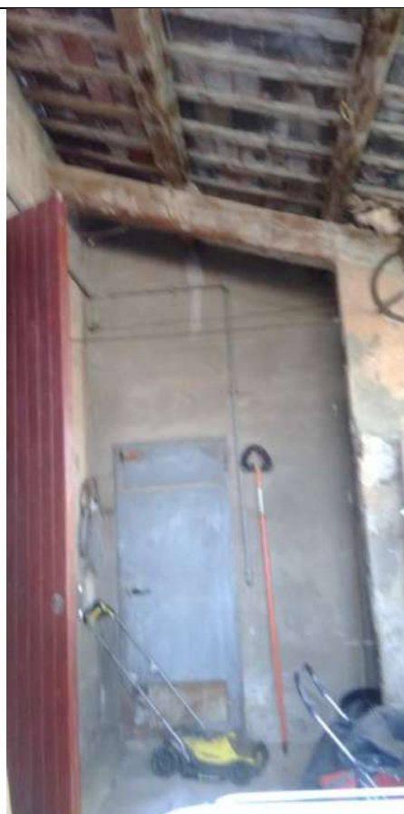
Particolare dell'ingresso alla centrale termica
