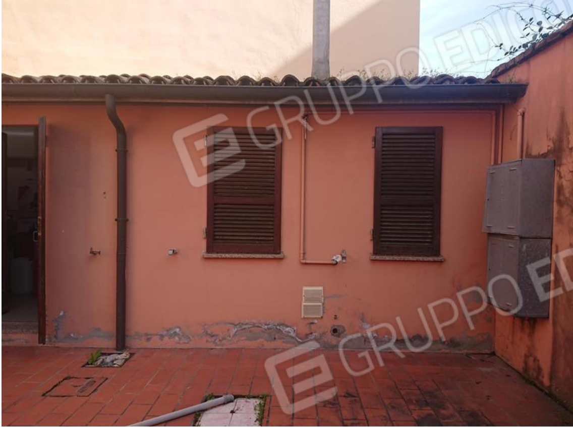
FOTO 10. Corta esclusiva: angolo con i contatori delle due unità immobiliari del fabbricato
